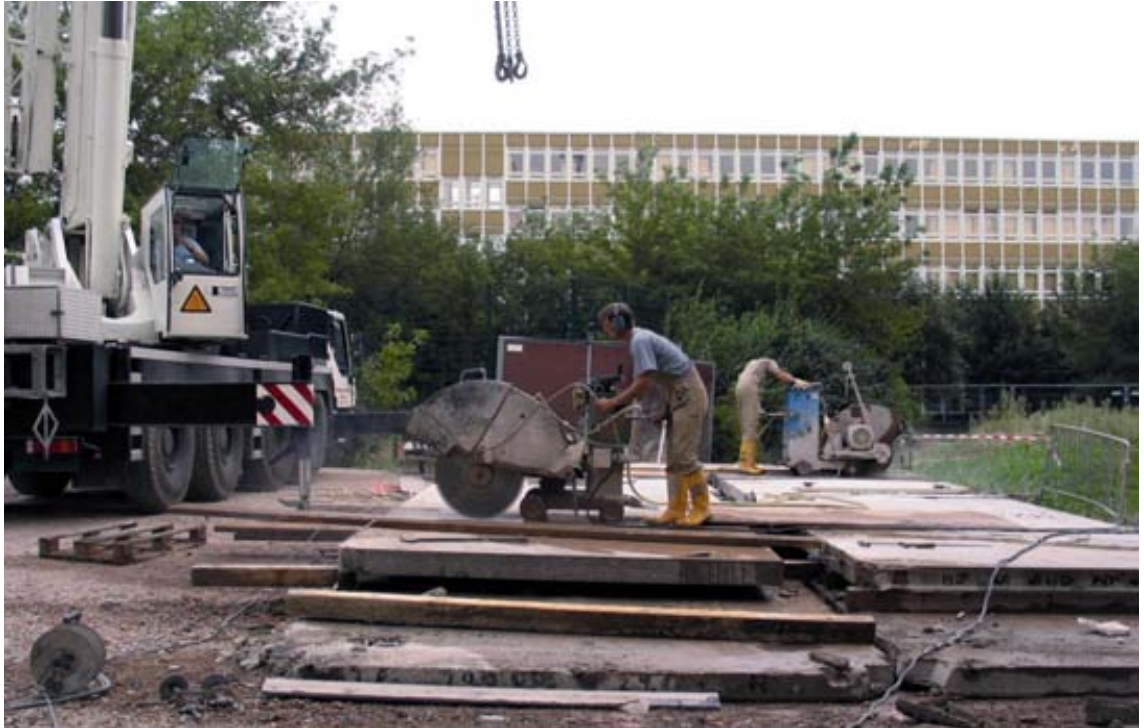
Elementtejä leikataan timanttisahalla haluttuun kokoon jo purkutyömaalla (Asam). Kyseessä on kohde 6.3 Ringkolonnaden Westseite.
