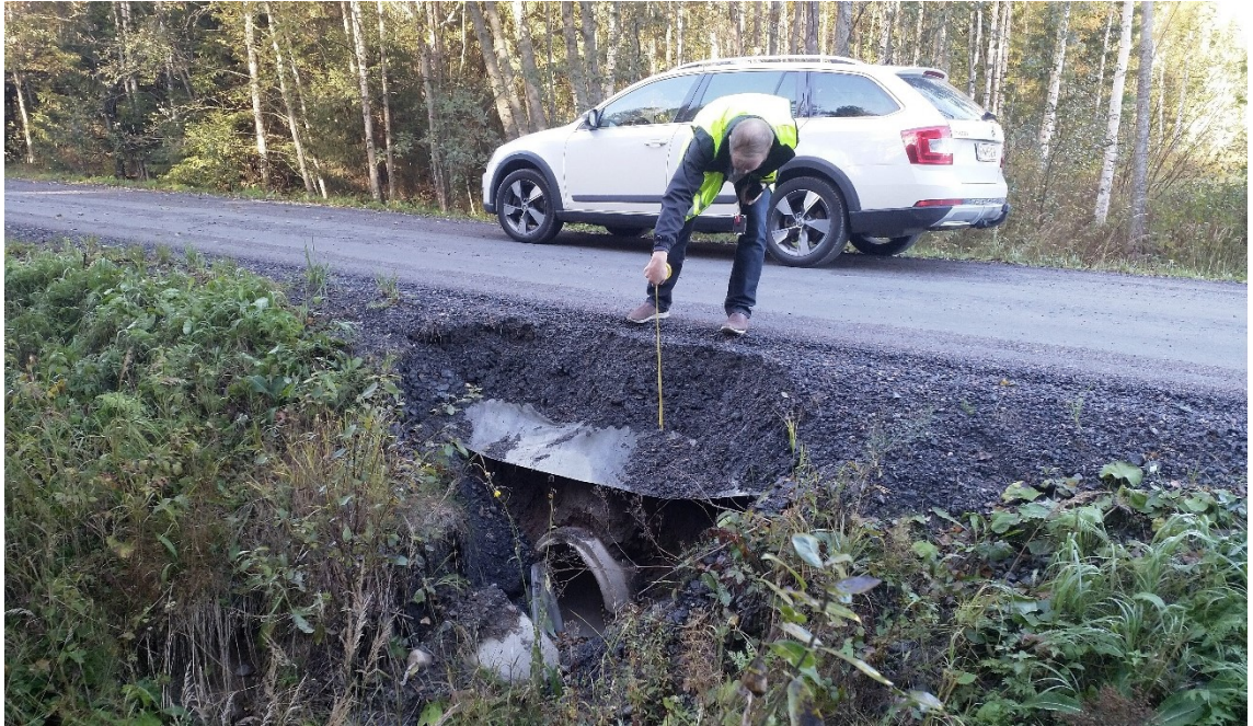
Kuva 21. Rumpurikko Siltasavontiellä mt 14276 tierekisteripaalulla 5495.
