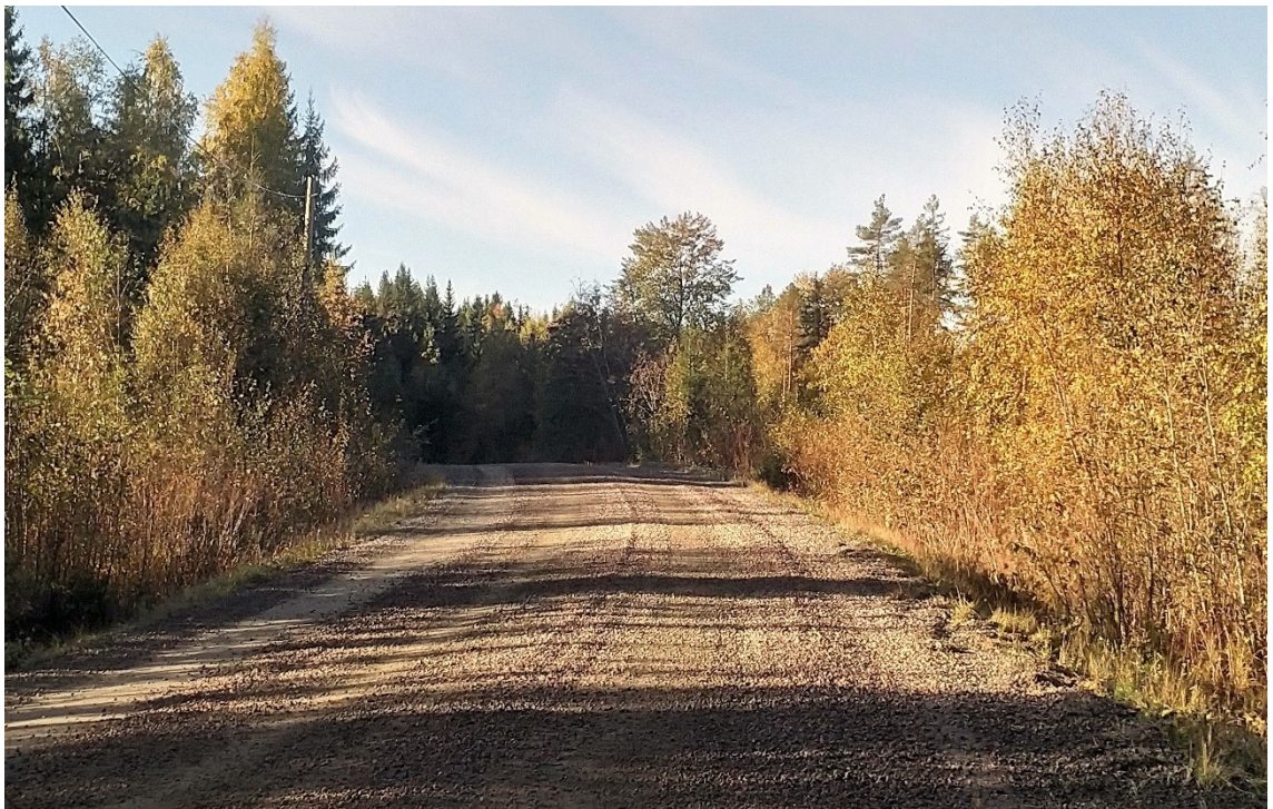
Kuva 20. Sorastusjälkeä Teiskon kirkkotiellä mt 3381 tierekisteripaalulla 5125.
