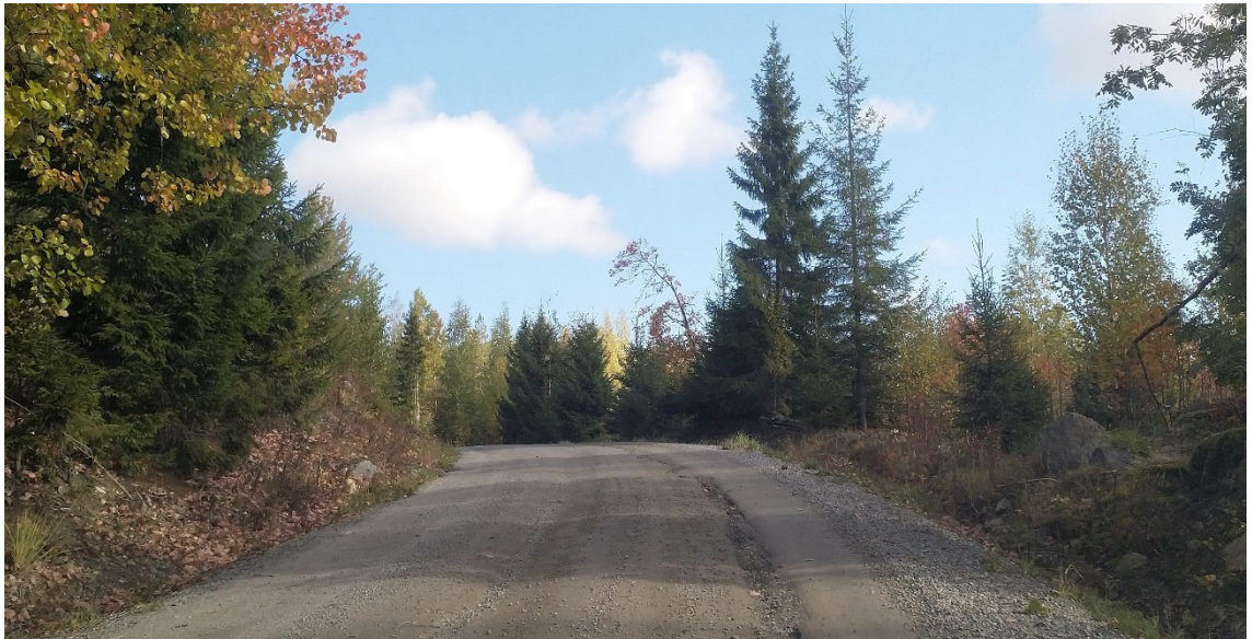
Kuva 22. Veden ja liikenteen syövyttämä ura kulutuskerroksessa, Siitamantie mt 14207 tierekisteripaalulla 2780.
