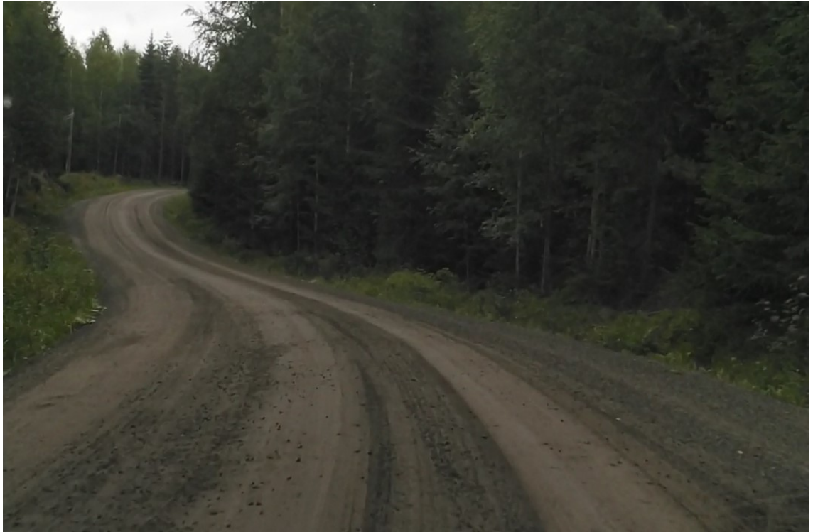
Kuva 24. Hautaantien mt 12995 kunnostamatonta osuutta 2.9.2018.
