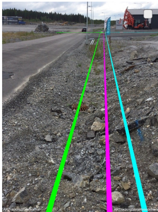
Kuva 28. AR-Sovelluksen näkymä heti kalibroinnin jälkeen. Kaapeliputki vihreällä värillä, keskijännitekaapeli violetilla ja pienjännitekaapeli sinisellä.
