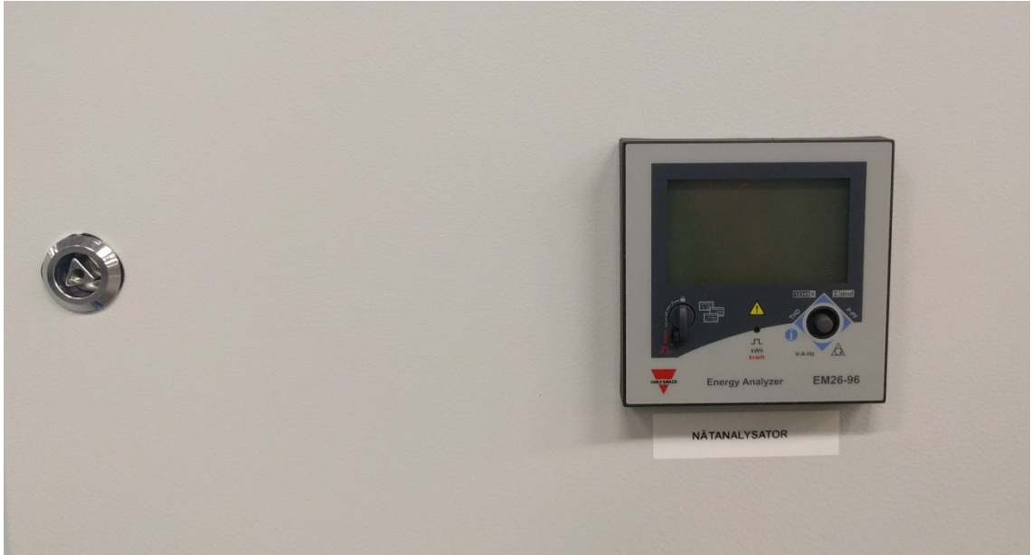
Kuva 3. Oveen asennettu verkkoanalysaattori.
