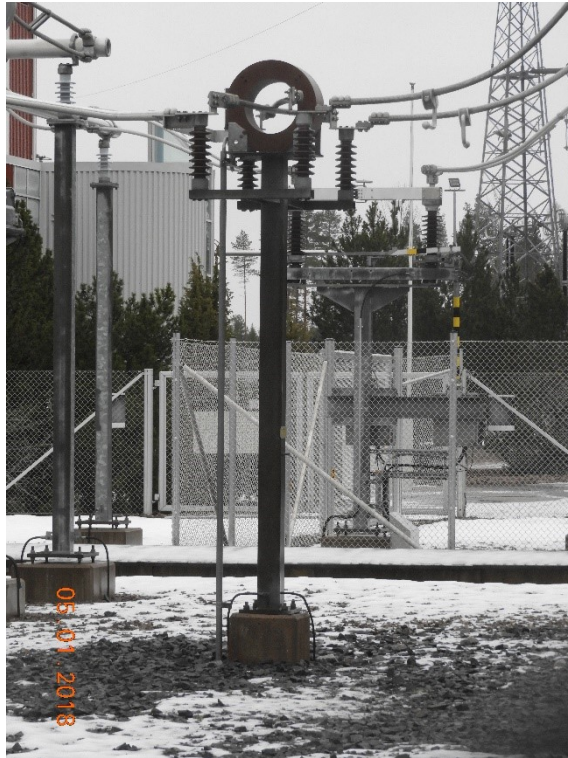
Kuva 15. Elektrodipiirin erovirtamuuntaja kuvattuna Rauman suuntaaja-aseamalla.
