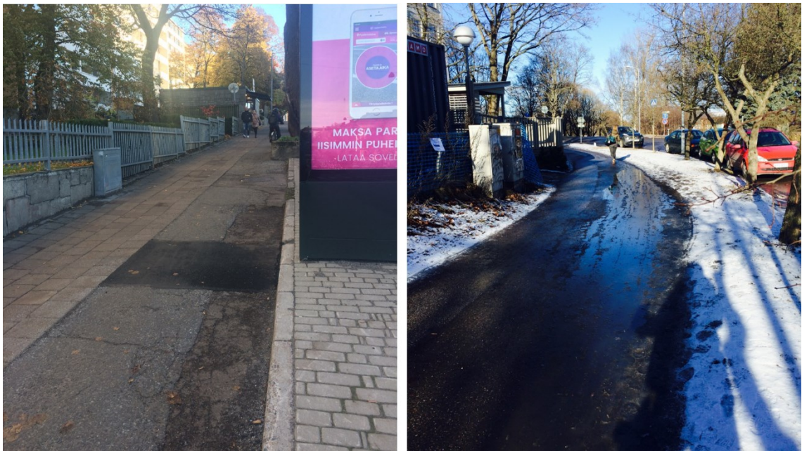
Kuva 66 Kuvassa vasemmalla on esimerkki heikkokuntoisesta päällysteestä ja oikealla heikosta kuivatukselta ennen kunnostustoimenpiteitä. (Kuvat: Anette Korkiakangas)
