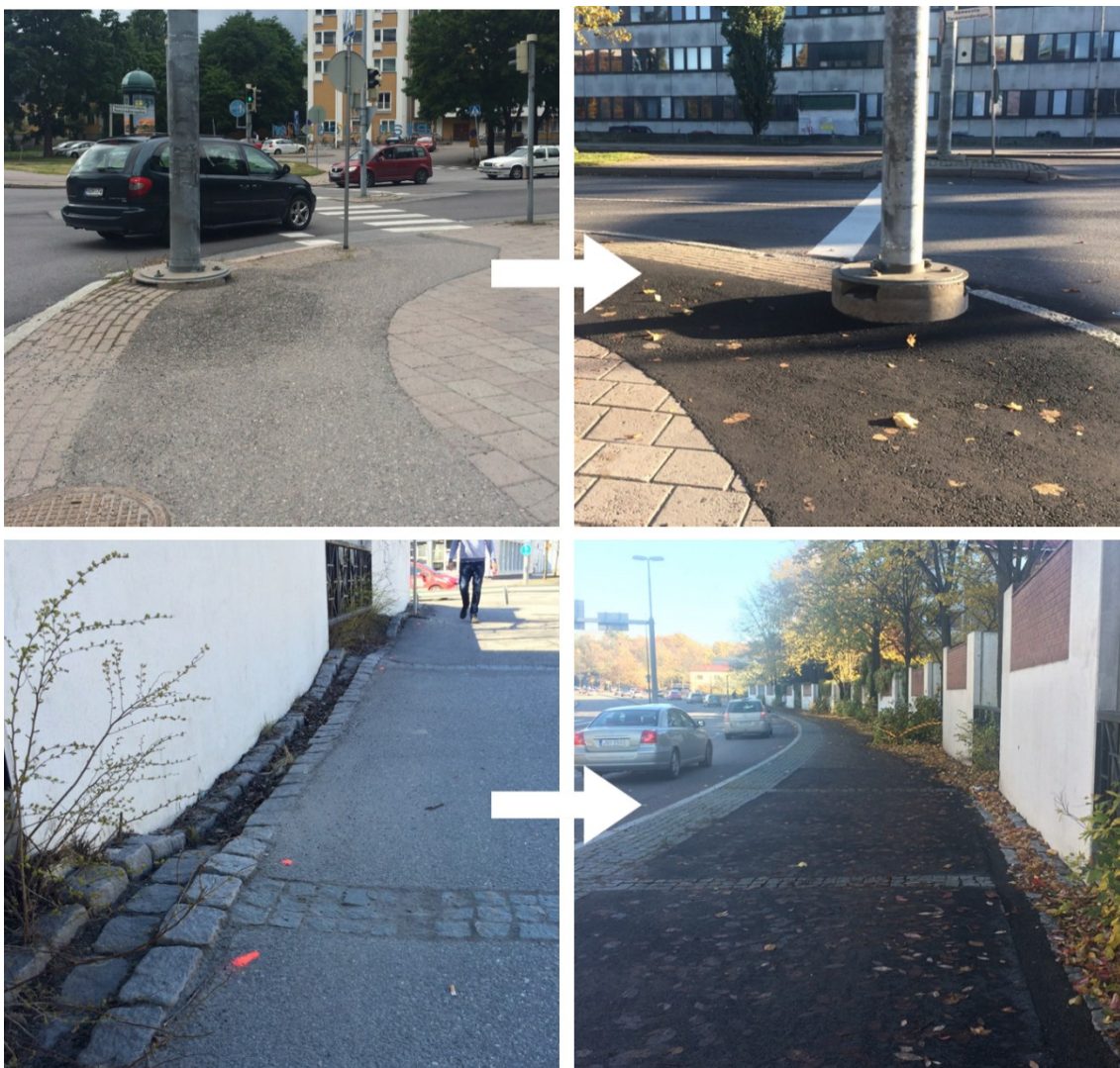
Kuva 67 Testireitillä suoritetussa kuntokartoituksessa havaitut epätasaisuudet korjattiin. Vasemmalla on esitetty kuvat lähtötilanteista ja oikealla kuvat korjaustoimenpiteiden jälkeen. (Kuvat: Anette Korkiakangas)
