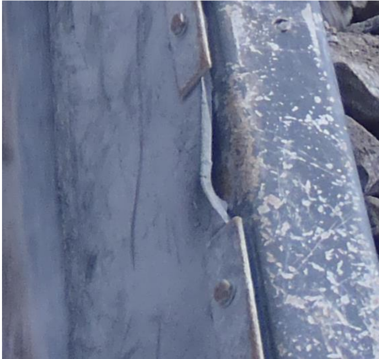
Kuva 40. Lämpövenymän osin aiheuttama kumin pullistuma
