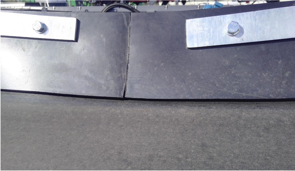
Kuva 48. Puutteellinen jatkos, osa 2
