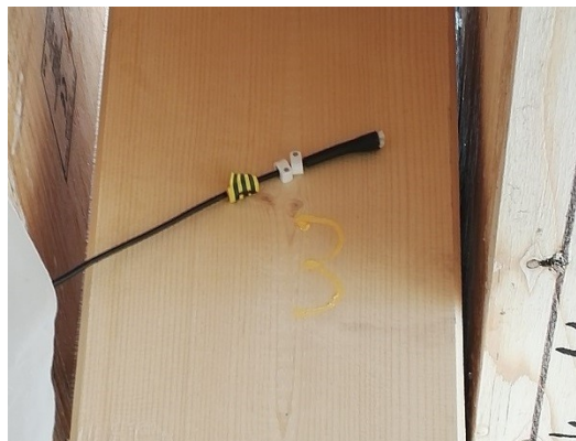
Kuva 2 Lähikuva RF SensIT:in toteuttaman olosuhdemittauksen anturi pilarin kyljessä kohteessa (RF SensIT Oy)
