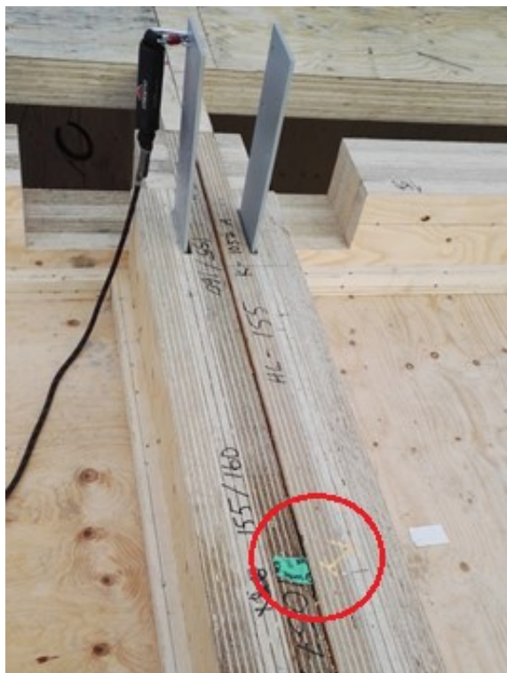
Kuva 13 Anturin asennuspaikan sijainti välipohjaelementtien välissä (RF SensIT Oy)
