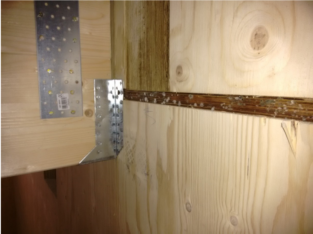
Kuva 3.18. Homeen kasvua koivuvanerin reunassa 2. kerroksen porraskäytävällä väli-seinän yläosassa (13.3.2017).
