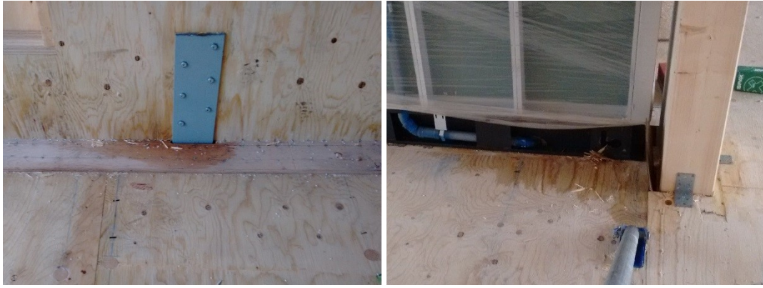
Kuva 3.13. Kastuneet teräslevyn (vas.) ja pilarin (oik.) läpiviennit välipohjan läpi 3. kerroksessa (26.1.2017).
