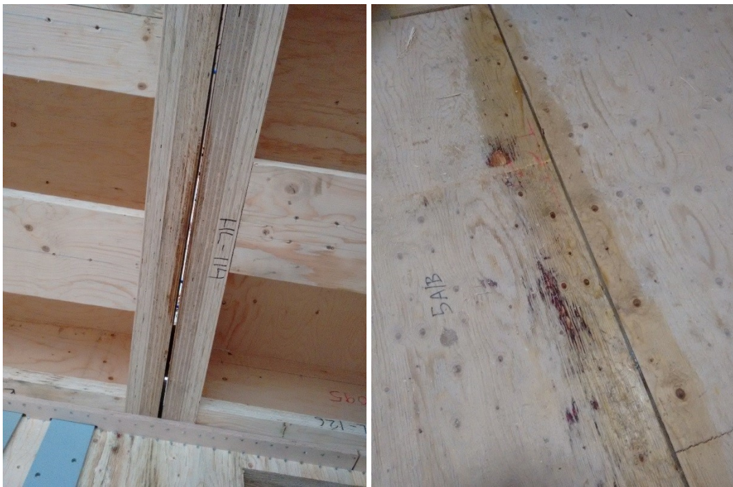
Kuva 3.14. Havaintoja valuvasta vedestä välipohjaelementtien päätyjen (vas.) ja sivujen (oik.) välistä 3. kerroksessa (26.1.2017).
