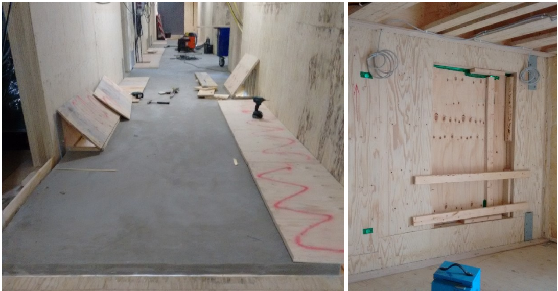
Kuva 3.20. Sementtipohjainen lattiavalu ja avatut läpiviennit 3. kerroksen porraskäytävässä (vas.) ja väliaikaisesti teipattuja rakoja sekä reikiä kantavassa päätyseinässä (27.4.).
