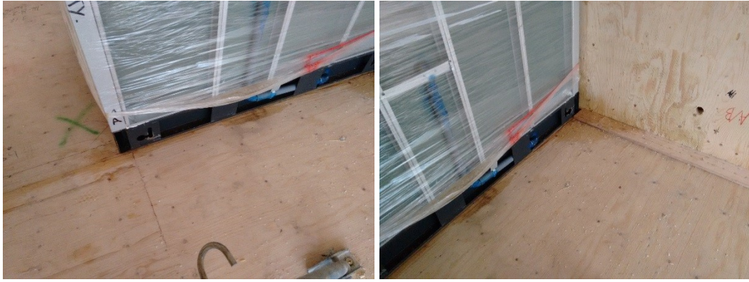
Kuva 3.15. Havainto valuvasta vedestä kylpyhuone-elementin ympärillä 3. kerroksessa (26.1.2017).
