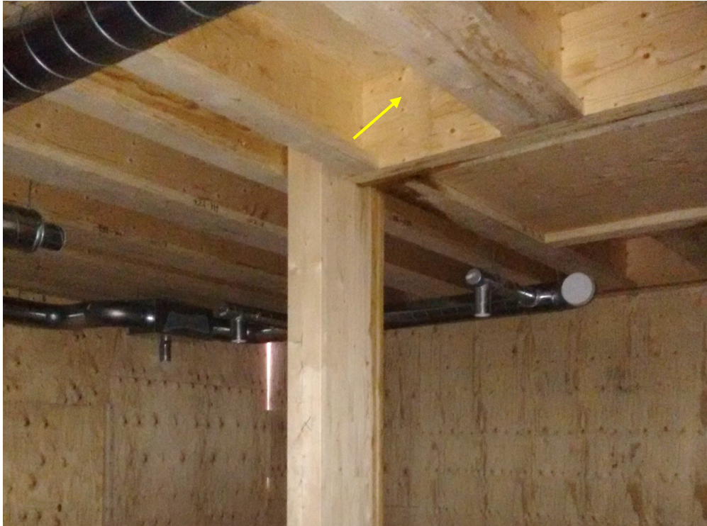
Kuva 14. Kylpyhuonesyvennys välipohjassa ja pilari sekä mittauspisteen 34 sijainti (vas. ripaväli ja 11 cm yläreunasta) (13.3.2017).
