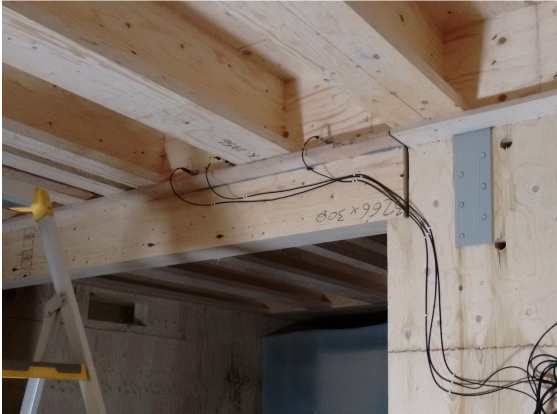
Kuva 22. Ripalaatat väliseinän ja aukkopalkin päällä sekä mittauspisteiden 17 (oik.), 19 (vas.) ja 20 (kesk.) sijainti (6.3.2017).
