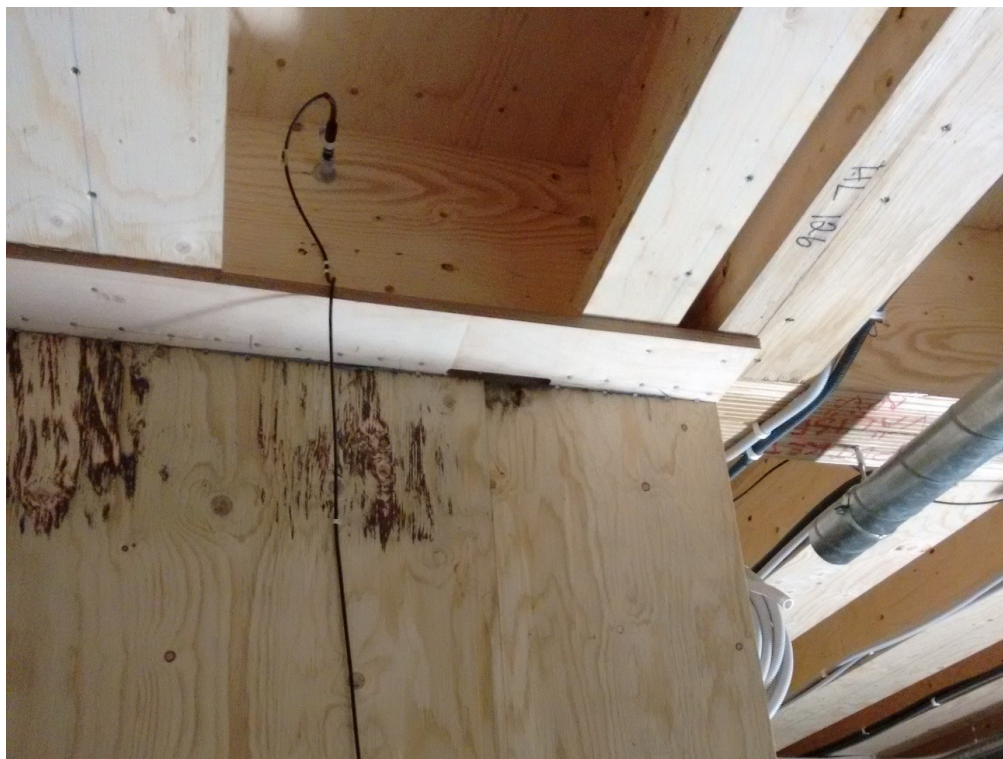
Kuva 18. Ripalaatta väliseinän päällä ja mittauspisteen 15 sijainti (16.2.2017).
