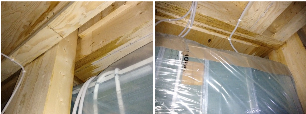
Kuva 3.17. Havainto valuvasta vedestä toisen kerroksen kaakkoispäädyn asunnon kylpyhuone-elementin kohdalla (13.3.2017).
