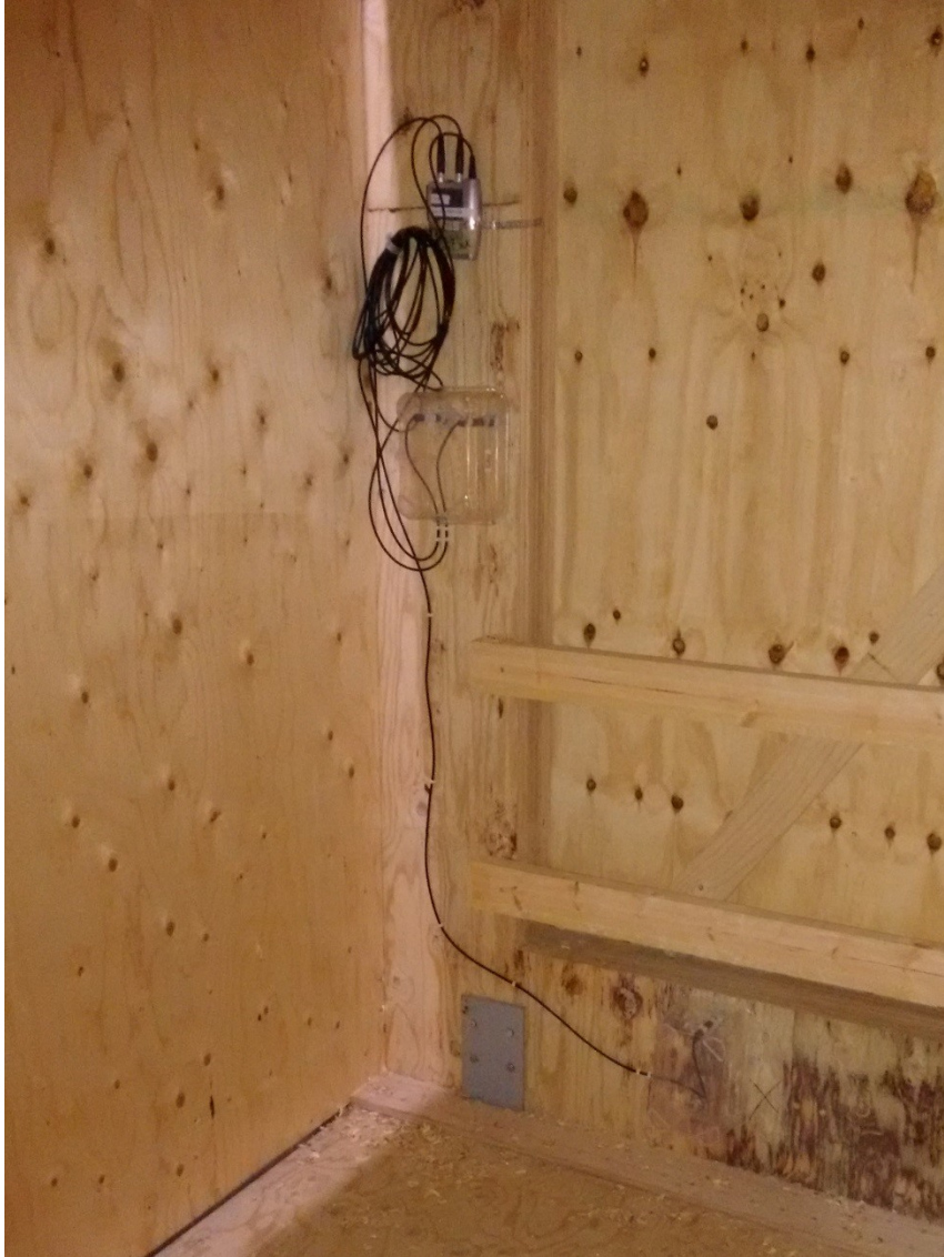
Kuva 8. Rakennuksen päätyseinän nurkka, väliaikaisia suojauksia ja mittauspisteiden 12 (kesk.), 13 (oik.) ja 14 (vas.) sijainti (16.2.2017).
