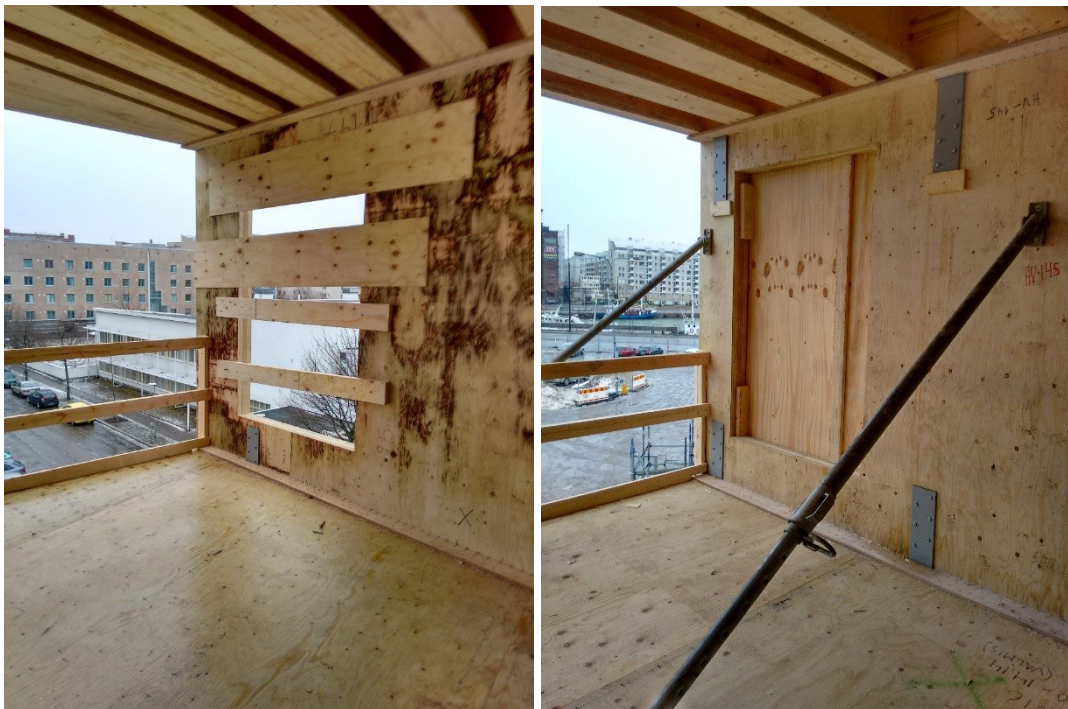
Kuva 3.12. Välipohjan kastuminen ilman sivuseinän suojauksia: kastunut luoteisnurkka (vas.) 4. kerroksessa ja kuivempi kaakkoisnurkka (oik.) 3. kerroksessa (26.1.2017).
