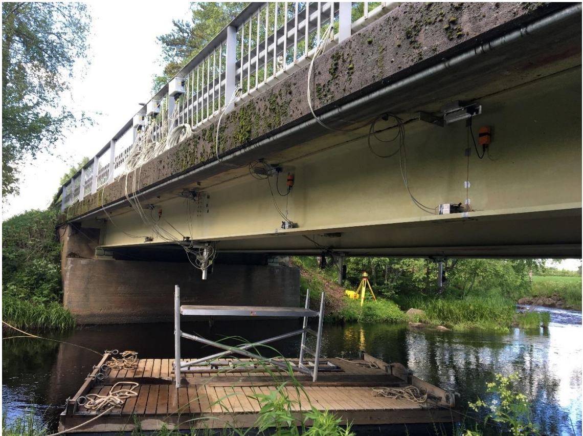
Kuva 4.13 Ronnalan sillan mittalaitteita sillan eteläpuolella
