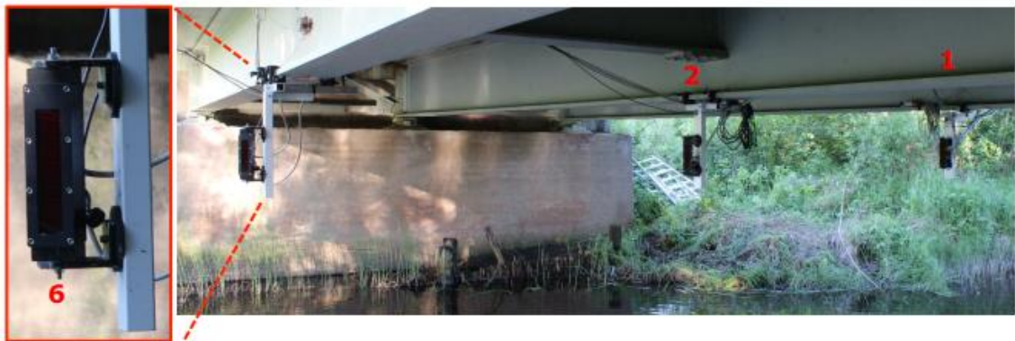
Kuva 4.15 DMM-tasoanturit asennettuna (Dimense Oy)
