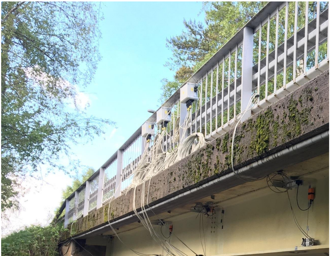
Kuva 4.18 Sillan kaiteeseen asennetut venymäluiskavahvistimet
