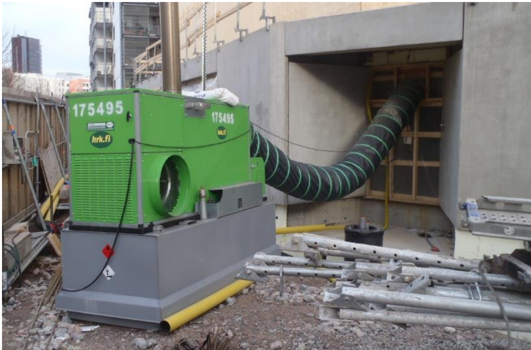
Kuva 4.9 Toinen polttoöljytoimisista lämpökonteista.
