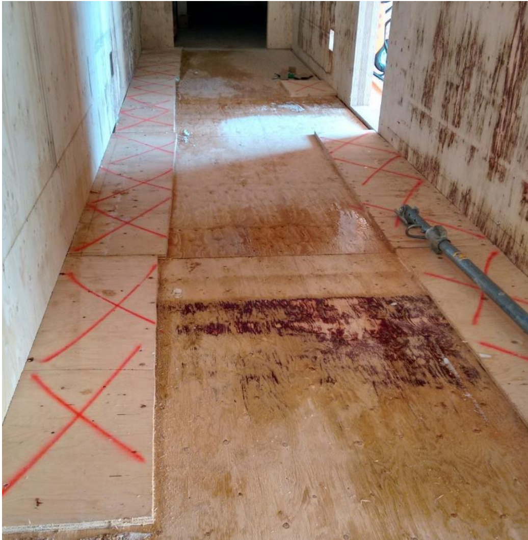
Kuva 4.18 Kosteutta 6. kerroksen käytävällä helmikuussa, jolloin asennukset olivat tauolla.
