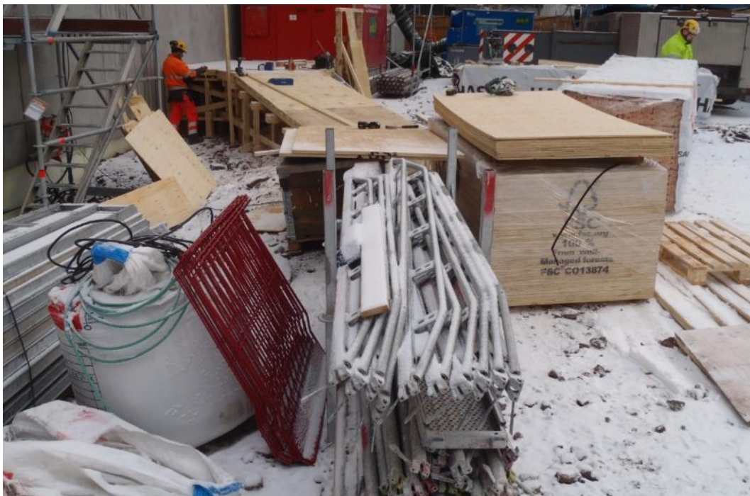
Kuva 4.22 Työmaan varastointi ei ollut kovin organisoitua ja materiaalit eivät aina olleet suojattuna.
