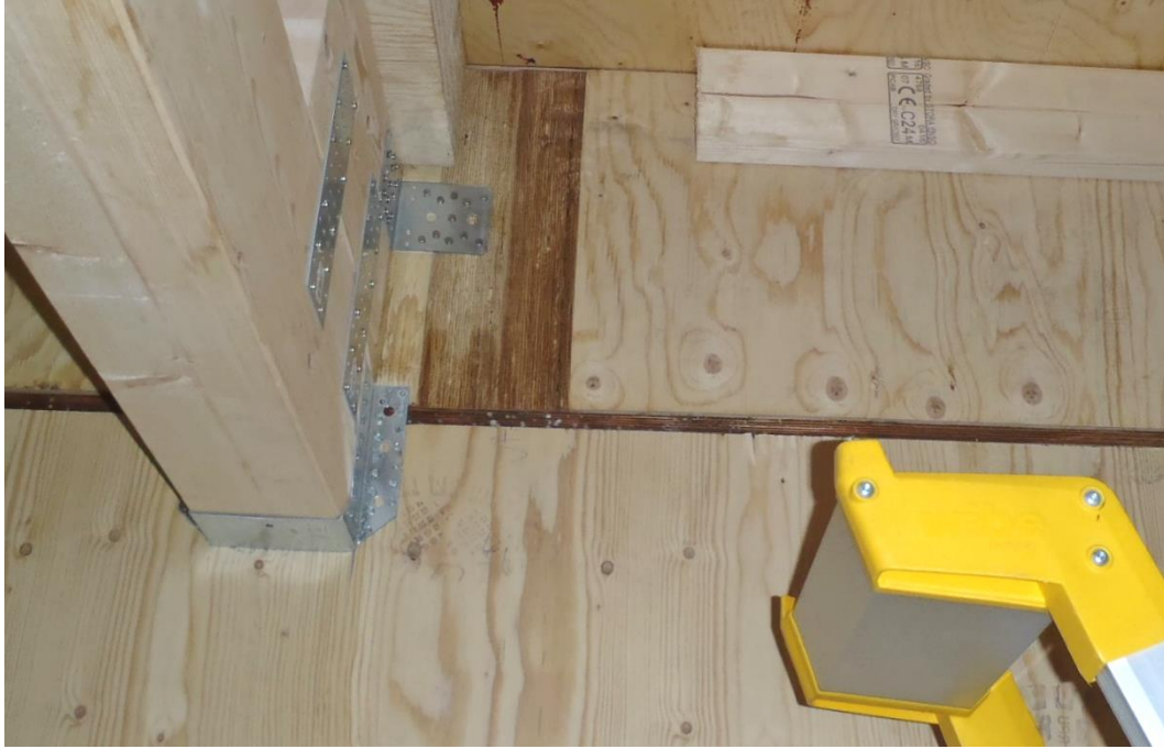
Kuva 4.17 Vaurioitunut kohta koivuvanerissa toisen kerroksen käytävällä. Havaittavissa pieniä valkoisia pilkkuja ja himmeämpiä tummia pilkkuja poikittaisessa koivuvanerissa.
