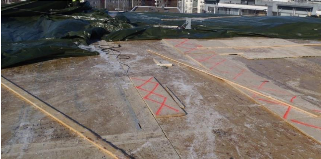
Kuva 4.5 Käytävän ja kylpyhuone-elementtien aukot on peitetty vanerilevyillä sadeveden valumisen ehkäisemiseksi.
