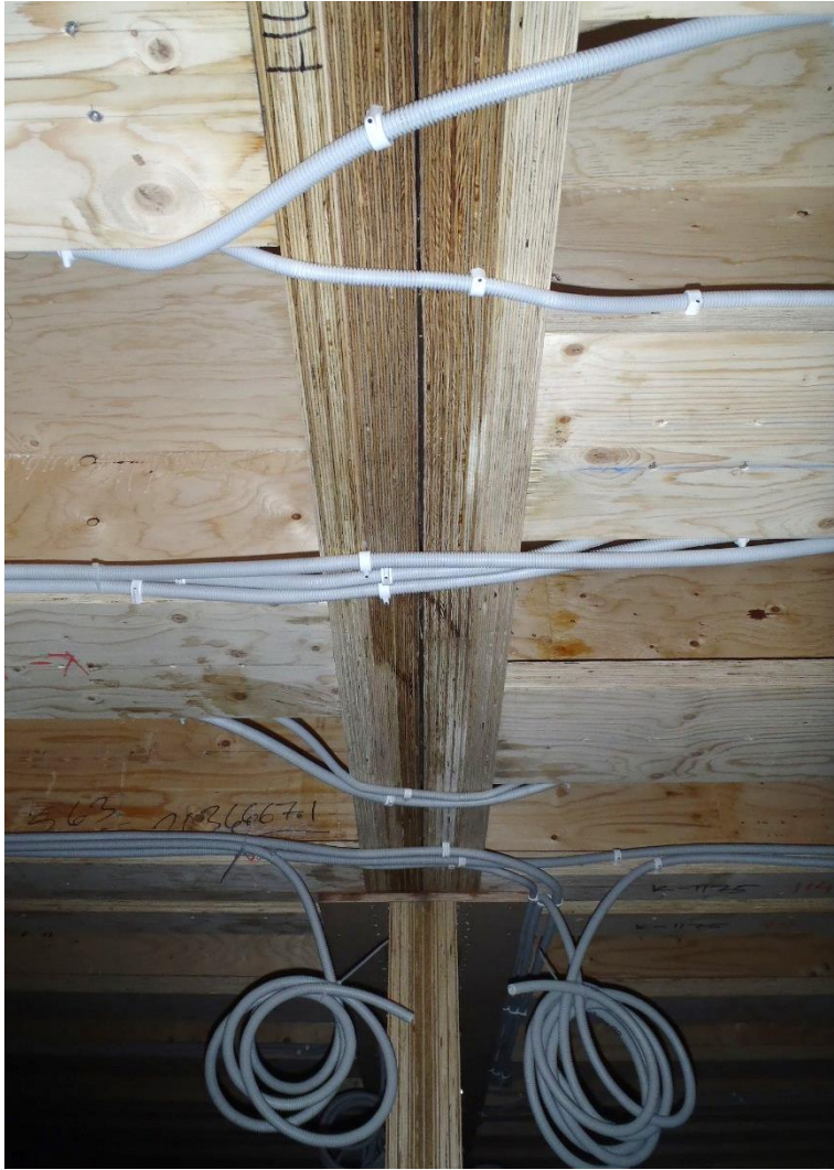
Kuva 4.19 Kohtaavien ripalaattaelementtien välissä olleita jälkiä kosteudesta.
