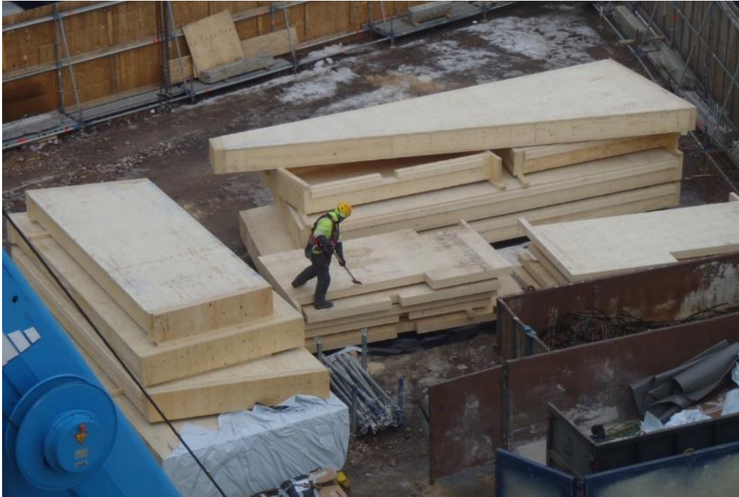
Kuva 4.21 Elementtien liian aikaisin aukominen aiheuttaa kosteusriskejä, mikäli asennukset viivästyvät.
