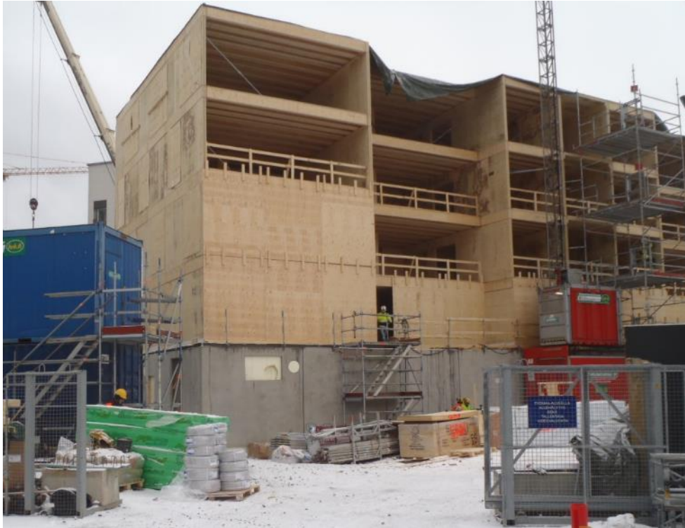
Kuva 4.20 LVL-levyjen asennuksen viivästyttyä runko oli säälle alttiina.
