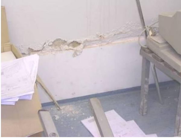
Kuvat 3.34. Tiilimuuratun seinän alaosaan on asennettu rakennuslevy, jolla on pyritty piilottamaan kosteuden aiheuttamat pinnoitevauriot. Kosteuden haihtumisrintama on noussut levyn yläpuolelle ja vauriot ovat uusiutuneet.
