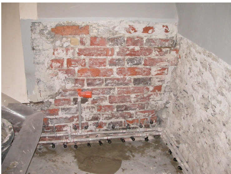
Kuva 4.13. Seinän alaosaan on tehty paineellisena injektointina kapillaarikatkovyöhyke. Vanhat rappaukset on poistettu vaurion yläpuolelle ulottuvana vyöhykkeenä. Patteriputket ovat korjauksen aikana paikoillaan, mutta suojattuna muovilla.
