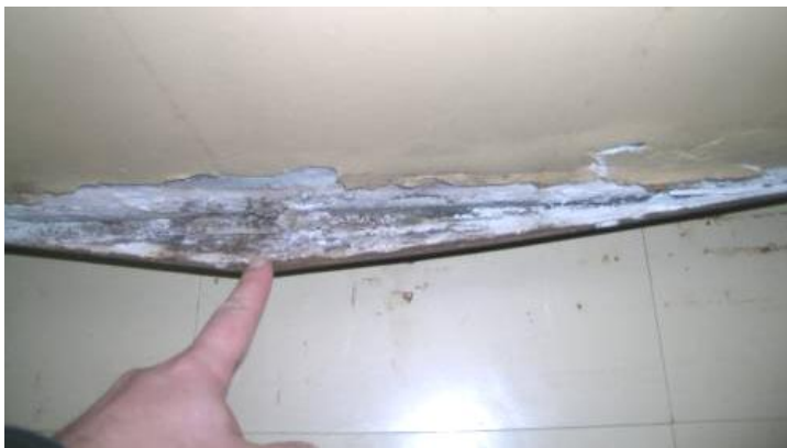
Kuva 3.32. Maanvastaiseen betoniseinään asennetun muovisen jalkalistan taustapinnan kiinnitysliima on mikrobivaurioitunut rakenteessa olevan kosteuden vaikutuksesta.
