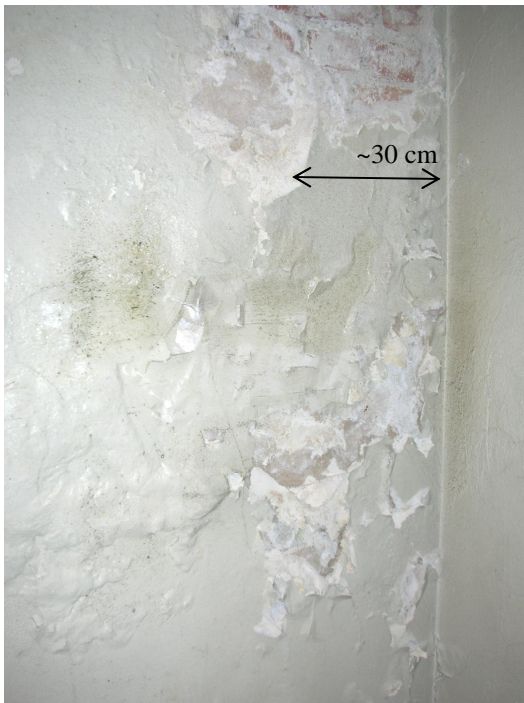
Kuva 3.21. Laaja-alaista rappaus- ja suolavauriota massiivitiilirakenteen sisäpinnalla.
