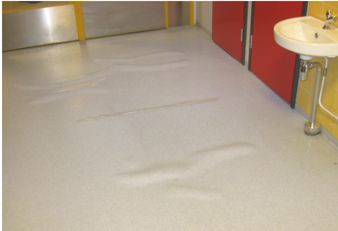
Kuva 3.31. Lattiapinnoite on noussut laajoilta alueilta koholle maanvastaisessa alapohjassa.
