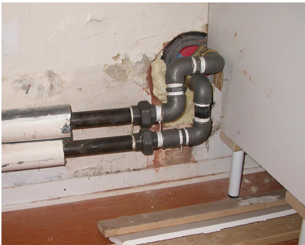
Kuva 3.36. Maanvastaisessa seinässä sijaitseva epätiivis putkiläpivienni on aiheuttanut ympärillä olevan rappauksen kastumisen.
