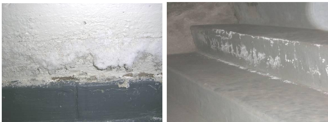
Kuvat 3.18. ja 3.19. Betonirakenteiden pinnalle kiteytyneitä suoloja.
