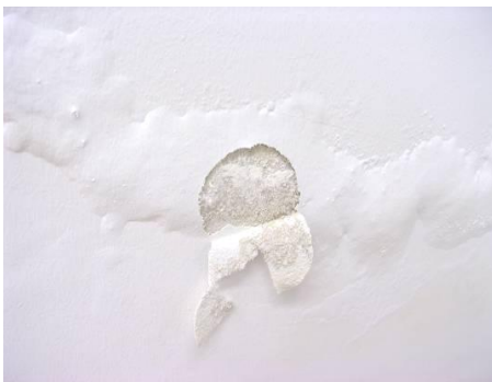
Kuva 3.23. Maalipinnan alle kiteytynyttä suolaa.
