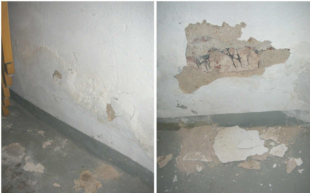
Kuva 3.38- 3.39. Muuta lattiapintaa noin 40 cm alemmalla tasolla sijaitsevan varaston väliseinän alaosassa on suolakiteytymävyöhyke. Myös varaston lattian maalipinta on hilseillyt kosteuden vaikutuksesta. Seinärakenteen alkuperäinen kapillaarikatko sijaitsee ylemmän lattiapinnan tasolla, jolloin vauriot ovat syntyneet pääosin kapillaarikatkon alapuolelle.
