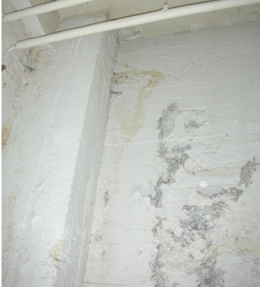
Kuva 3.22. Tyypillistä maanvastaisen betoniseinän sisäpinnalla esiintyvää maalin hilselyä kosteuden vaikutuksesta. Seinän betoni oli hyvin heikkolujuuksista ja vettä läpäisevää. Pilarin ja seinän liittymärakenteissa esiintyy jopa vesivuotoa.
