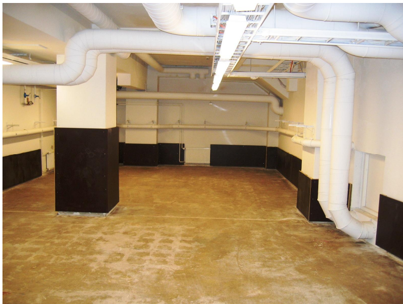
Kuva 3.43. Toisarvoisissa tiloissa kosteuden aiheuttamat vauriot voidaan peittää levyttämällä rakenteiden alaosat taustasta irti olevalla, tuulettuvalla levyllä. Kiteytyneet suolat varisevat vähitellen lattialle.
