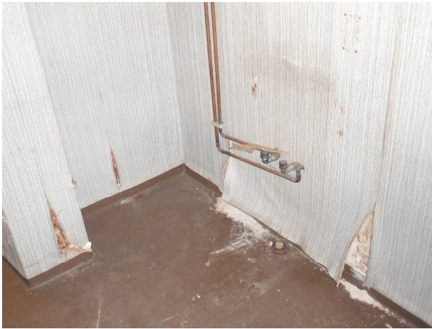
Kuvat 3.35. Kylpyhuone, jossa massiivitiiliseiniin pintaan on asennettu muovitapetit. Tapettien saumat ja alaosat ovat irtoilleet, kun saumojen kautta haihtuneen kosteuden kuljettamat suolat ovat kiteytyneet rappaukseen.
