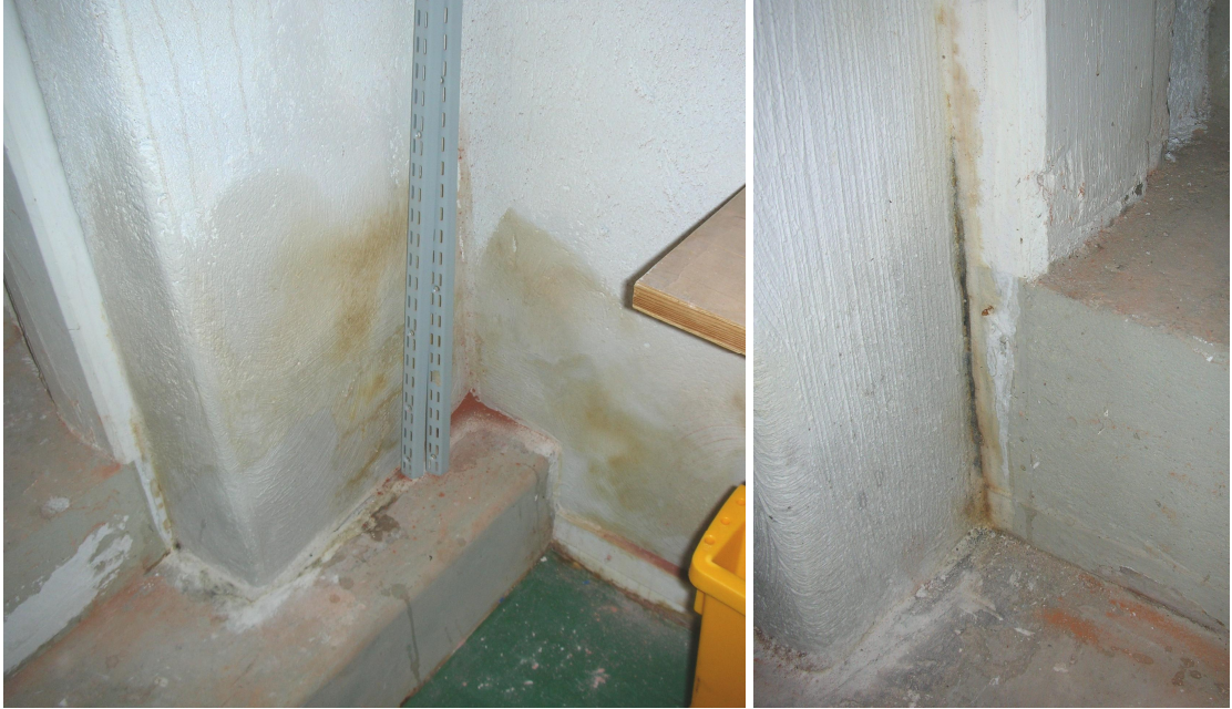
Kuva 3.40- 3.41. Varaston massiivitiiliseinien alaosat ovat kastuneet läpeensä kapillaarisesti nousseen kosteuden vaikutuksesta. Oven karmi on upotettu osin rappauksen sisään ja sen alaosat ovat jääneet varastoon tehdyn betoniaskelman ja seinän väliin, mikä on aiheuttanut karmiin näkyvää mikrobikasvua.
