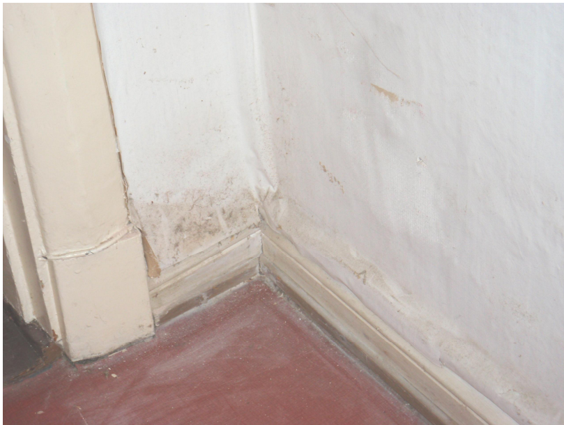
Kuva 3.25. Seinän alaosan tapetit ovat homehtuneet jalkalistan yläpuolelta alla olevan tiilirakenteen kosteuden vaikutuksesta. Näkyvää hometta löytyi myös tapettien alta rappauksen pinnasta.
