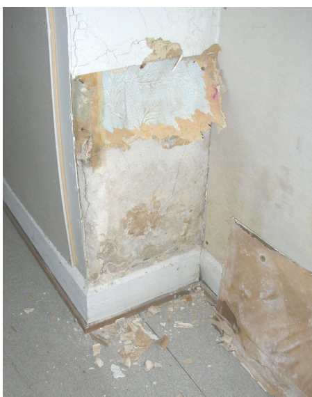
Kuva 3.33. Väliseinän päälle on asennettu huokoinen kuitulevy ja paikoin myös kovalevyä. Irrotetun kovalevyn takana rappaukset ovat kosteita ja vanhat tapetit sekä rappauksen pinta ovat homehtuneet. Vauriot jatkuvat myös kuitulevytyksen takana.
