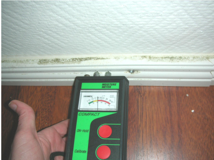
Kuva 3.26. Kosteusongelmaisen tilan lattiaan on asennettu laminaattipäällyste ja rapattuihin massiivitiiliseiniin maalatut lasikuitutapetit. Puisen jalkalistan kosteus on noin 18-painoprosenttia, lasikuitupinnoitteen alla oli havaittavissa alkavia rappausvaurioita ja jalkalistan päällä vihertävää hometta.
