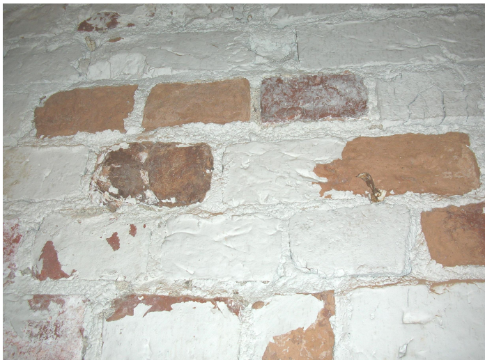
Kuva 3.11. Tiilien erilaisista polttoasteista ja huokosrakenteesta johtuen kosteus voi ilmetä vain joissain tiilissä pintavaurioina viereisten tiilien ollessa ehjiä.
