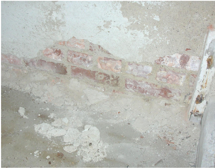
Kuva 3.24. Pitkälle kehittyneitä rappauksen rapautumista kosteuden ja suolojen vaikutuksesta.
