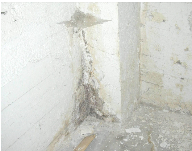
Kuva 3.15. 1930-luvulla rakennetun rakennuksen maanvastaisen betoniseinän ja -pilarin rajapinnassa on vesivuotokohta. Ylempänä maanvastaisessa seinässä on runsaasti heikkolaatuisen betonin läpi tulleen kosteuden aiheuttamia maalivaurioita.
