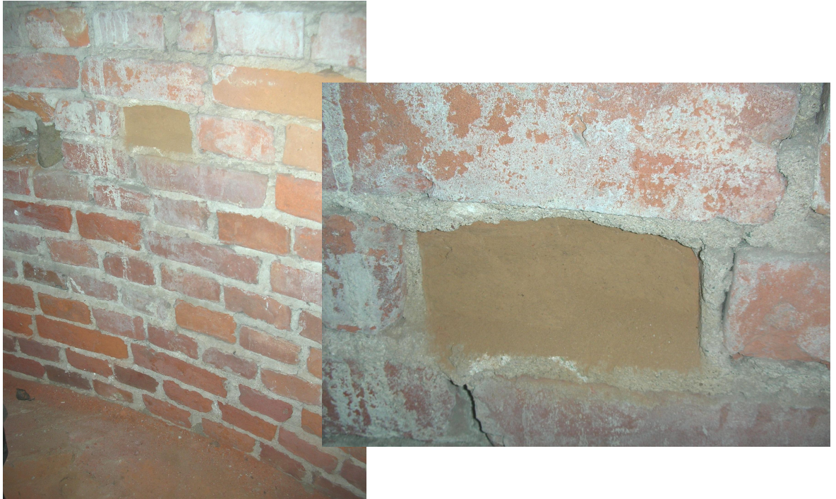
Kuva 3.10. Kylmän, 1840-luvulla rakennetussa rakennuksessa sijaitsevan varaston seinän vanha kalkkimaalaus on kulunut pois. Seinän alaosassa tiilien pinnat ovat vaurioituneet ja varisevat jauhona alas kosteuden ja liukoisten suolojen vaikutuksesta. Ylemmänä oleva heikkolaatuinen tiili on vaurioitunut muita syvemmälle tiilisyövän vaikutuksesta.
