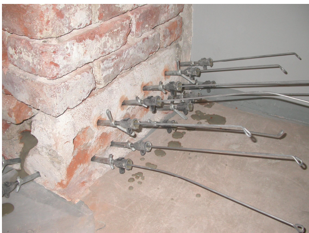
Kuva 4.15. Injektointireikiin on laitettu metallitangot, joiden avulla sementtilaastiin jää reiät varsinaisen injektointiaineen asentamista varten.
