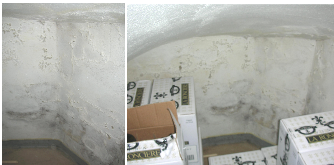
Kuva 3.12-3.13. Ruoka- ja juomavaraston ulkoseinissä on kondensoituneen kosteuden aiheuttamia kosteus- ja homevaurioita.
