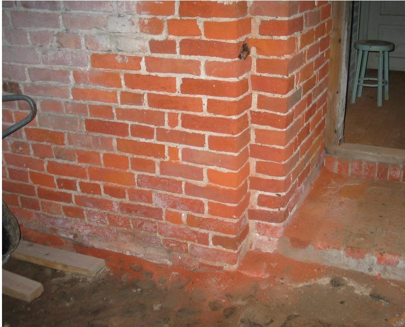
3.20. Kylmän varastotilan massiivitiiliseinän pinta varisee kosteuden vaurioittamana. Todennäköisesti vaurioitumisen osasyynä ovat tiilissä olevat hygroskooppiset suolat.
