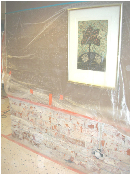
Kuva 4.6. Osittaiskorjaus kostealle massiivitiiliseinälle. Alustan puhdistusaste on riittämätön. Korjausalueen yläpuoliset seinäpinnat on suojattu muoveilla töiden suorituksen ajaksi, millä estetään säilytettävän pinnan pölyntyminen, mikä helpottaa huomattavasti korjauksen jälkeistä siivousta.
