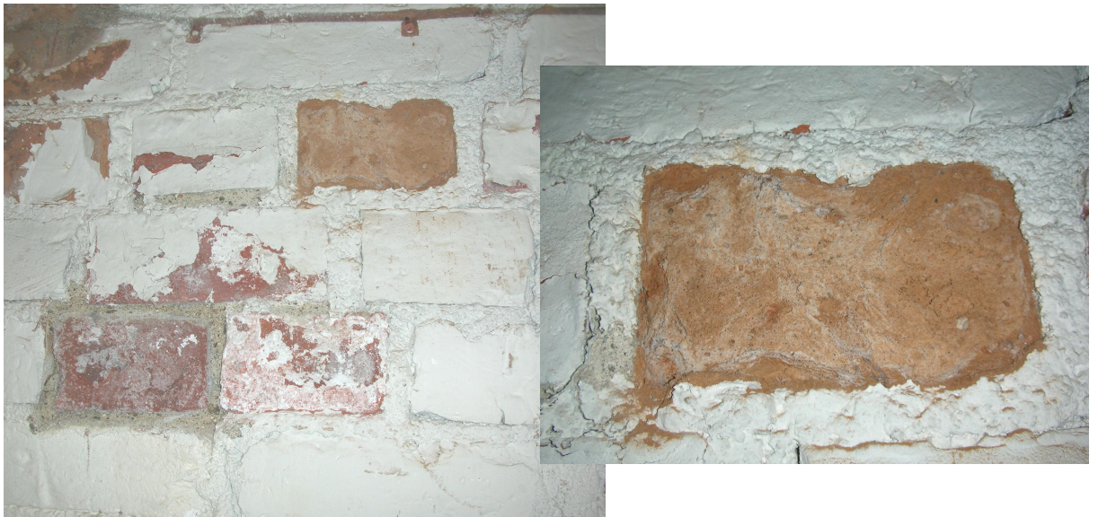
Kuva 3.9. Kosteuden ja suolan rasittama, nk. tiilisyövästä vaurioitunut tiili 1890-luvun lopulla rakennetussa rakennuksessa. Tiilisyöväälle on ominaista tiilen rapautuminen saumalaastien pysyessä ehjinä.
