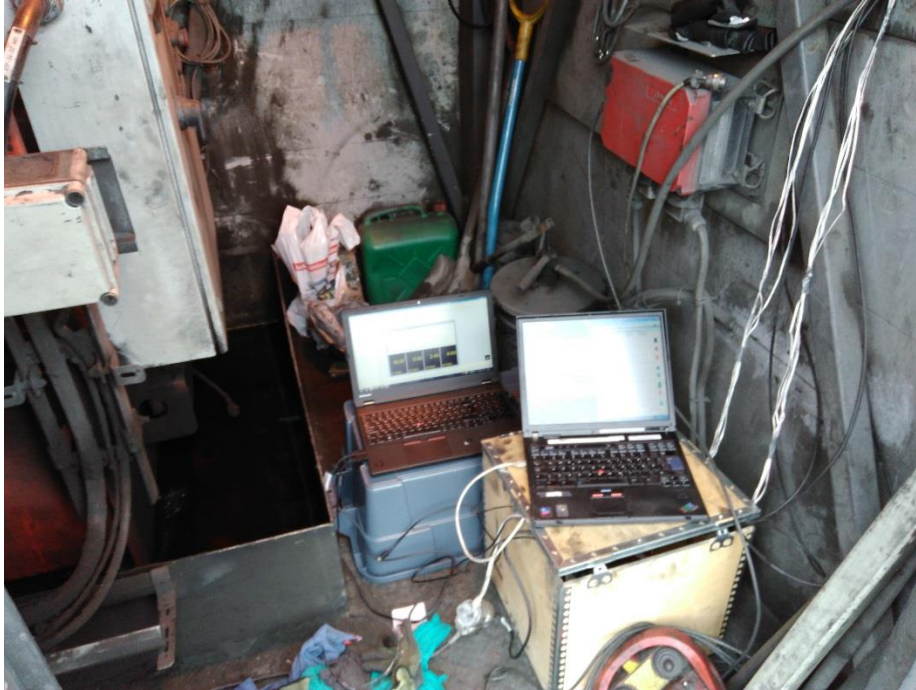
Kuva 31. Kenttäolosuhteissa, mittauslaitteet asennettuna hydraulikkakoppiin.
