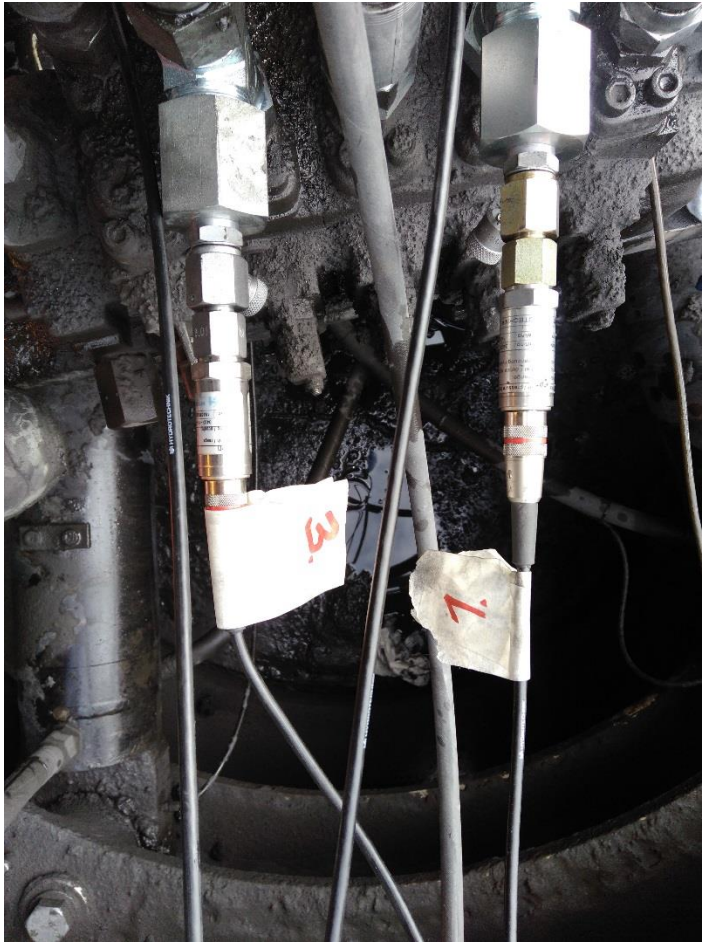
Kuva 28. Paineanturit on asennettu letkujen ja venttiilikoneiston väliin.
