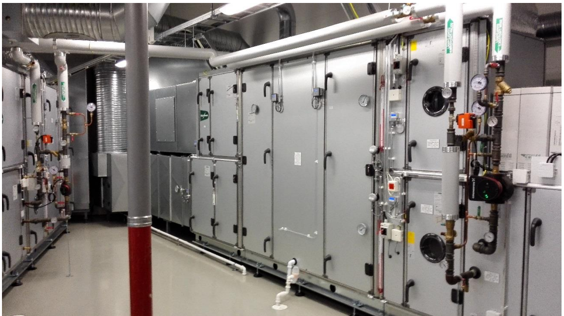
Kuva 11: Ilmanvaihtokonehuone oli tilava ja koneet helposti huollettavissa.
