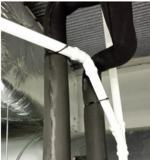
Kuva 19: Kondenssiviemäri oli kannakoitu nippusiteillä toisiin putkiin.
