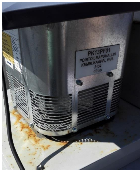
Kuva 20: Vetokaapin poistoilmapuhaltimen suojapelti oli ruostunut. Laitemerkinnät poistopuhaltimissa olivat yhtä lukuun ottamatta asianmukaiset. Osa katon poistoilmapuhaltimista värisi puhaltimen pyöriessä.
