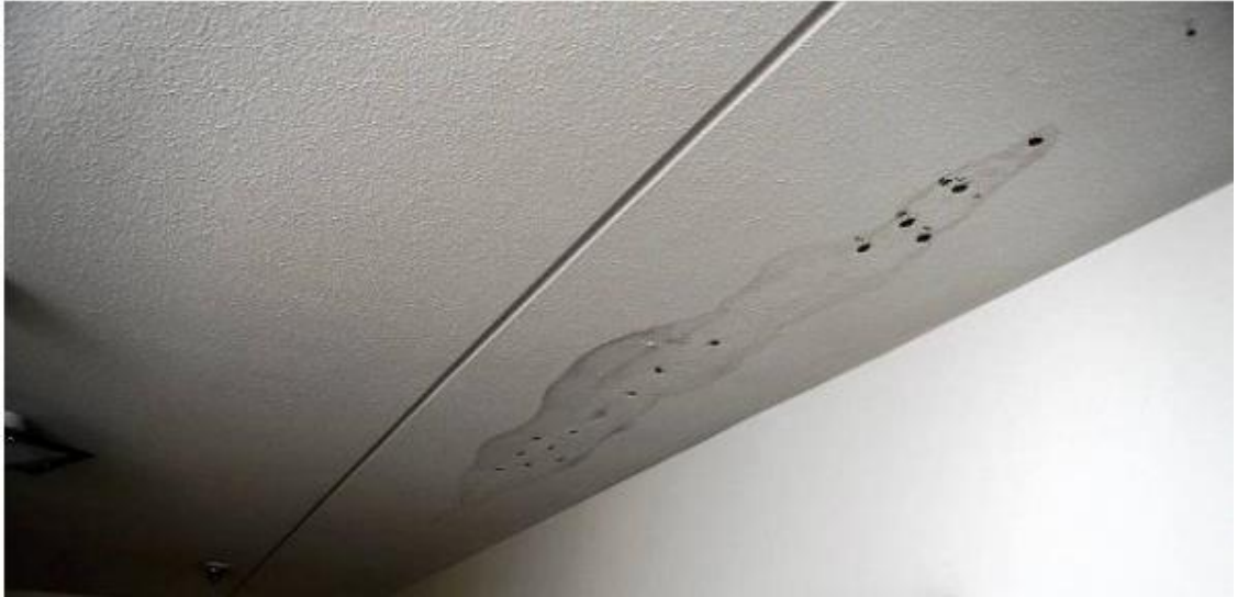
Kuva 2.1.2. Kuvassa on rakennuksen käytönaikana sattunut ontelovesien aiheuttama kosteusvaurio. Vaurioitunut kohta on tyypillisesti kantavan seinän viereisen ontelon alapinnalla. Onteloveden aiheuttama kosteusvaurio korjataan poraamalla reikiä ontelon kohdalle kattoon ja kuivattamalla ontelo. Kuivattaminen tehdään usein koneellisesti. (kuva: Ilta-sanomat 2013.)
