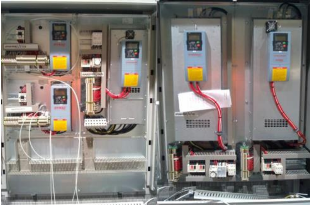
Kuva 3. Esimerkkikuva eri kokoisista inverttereistä (Konecranes Oyj 2010).
