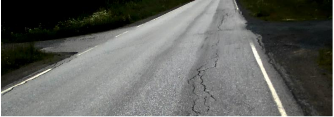
Kuva 5.4 Rinneahteen liittymän kohdalla havaitut vauriot (Ylöjärvi, Jonna Rossi 2015)
