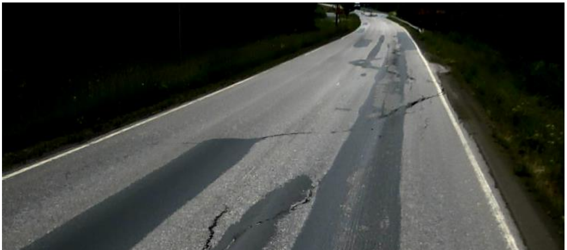
Kuva 5.5 2773/5/3300 kohdalla havaitut vauriot (Ylöjärvi, Jonna Rossi 2015)
