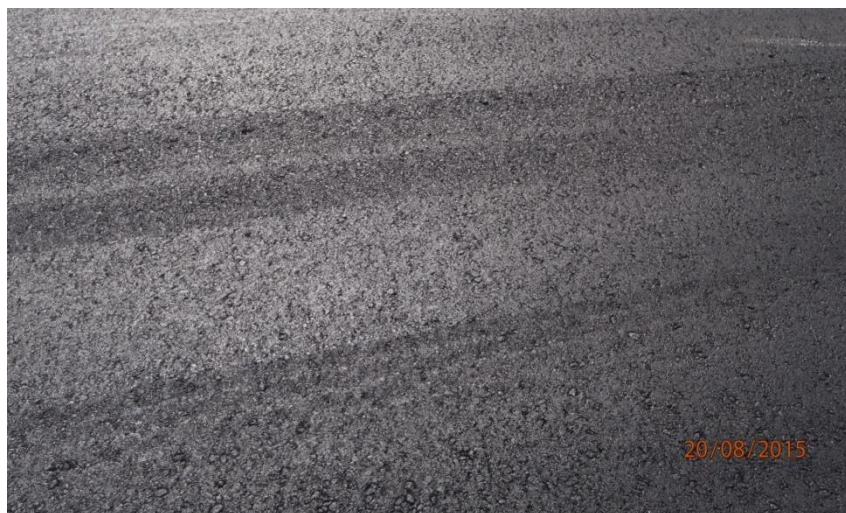
Kuva 6.23 Liikenteen aiheuttama päällysteen pinnan vauriot (Ylöjärvi, Jonna Rossi 2015)
