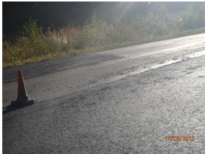
Kuva 6.8 Käsin korjattu keskisauma paalun 2773/5/20 kohdalla (Ylöjärvi, Jonna Rossi 2015)
