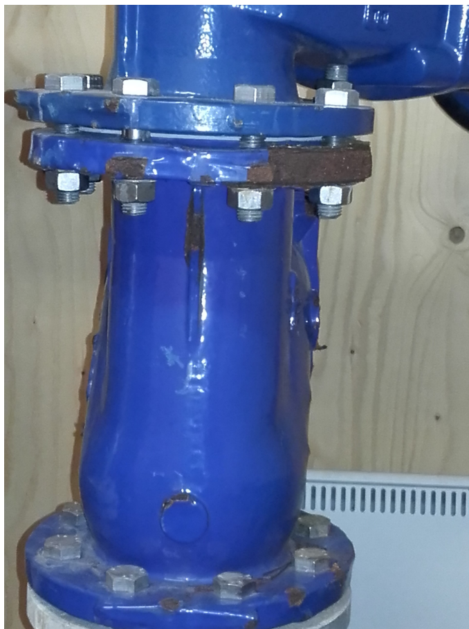
Kuva 14 Rikkivedyn aiheuttamia vaurioita putkiston pinnalla pumppamotilassa.
