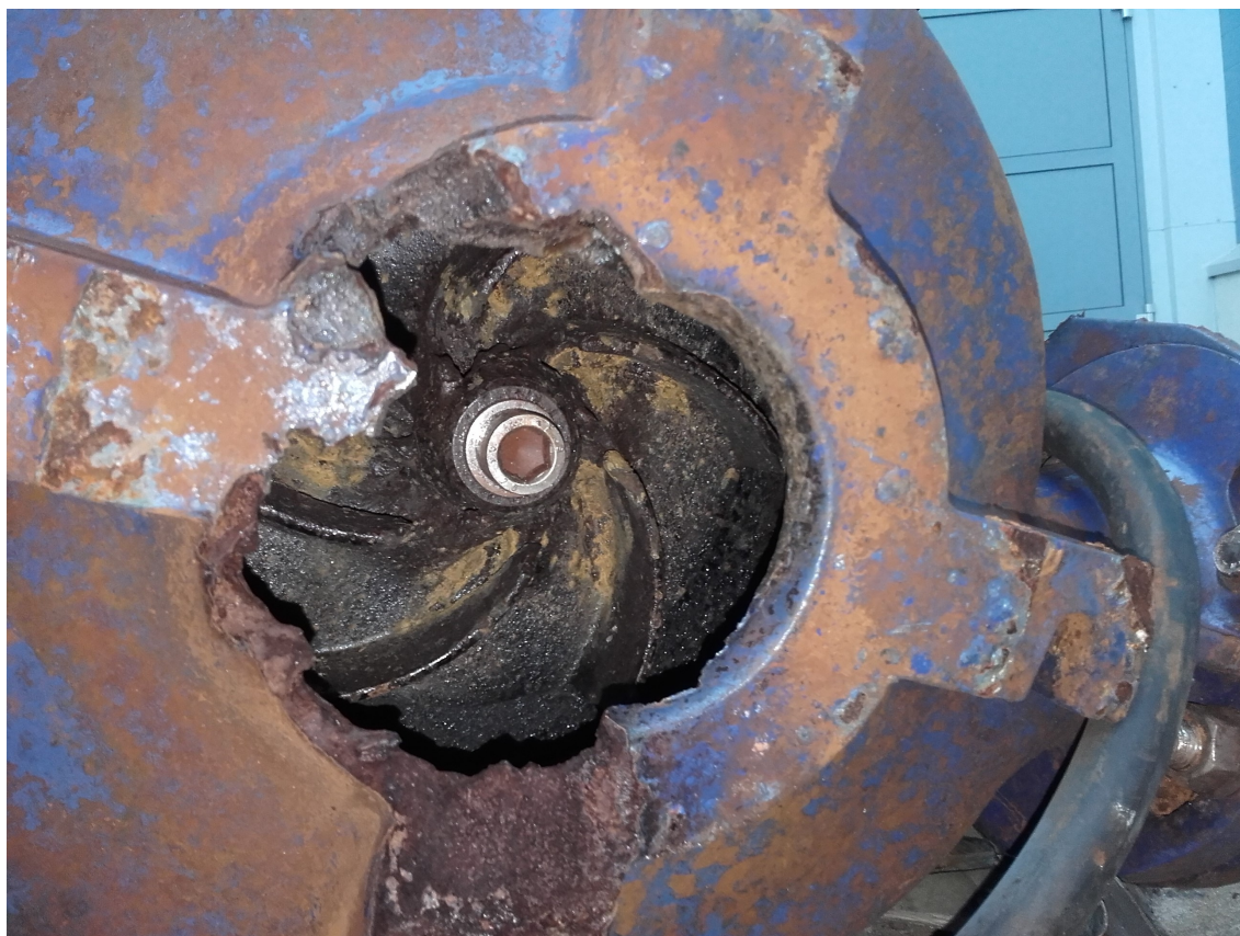
Kuva 20 Korroosiovaurioita Krogarsin jätevedenpumppaamolla käytetyssä pumpussa.
