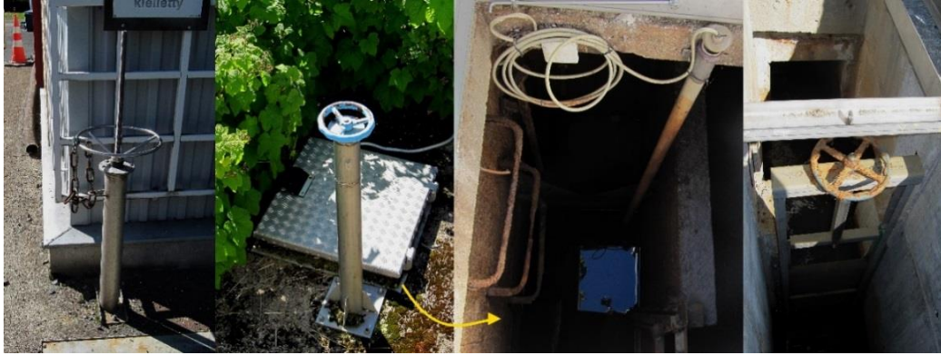
Kuva 2.8. Lempäälän jätevedenpuhdistamon ohitusjärjestelyitä. Vasemmalta oikealle: säätö koko puhdistamon ohittamiseksi, ohitusvesien kokoajakaivo, esiselkeytyksen jälkeinen ohituskanava ja sen virtaaman säätö.
