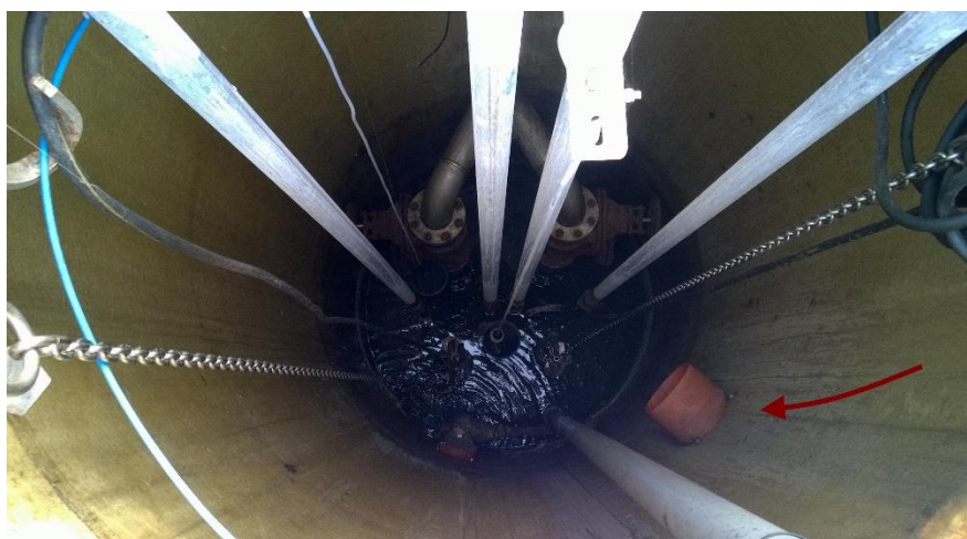
Kuva 2.5. Jätevedenpumppaamon ylivuotoputki. (Grundfos_a 2015)
