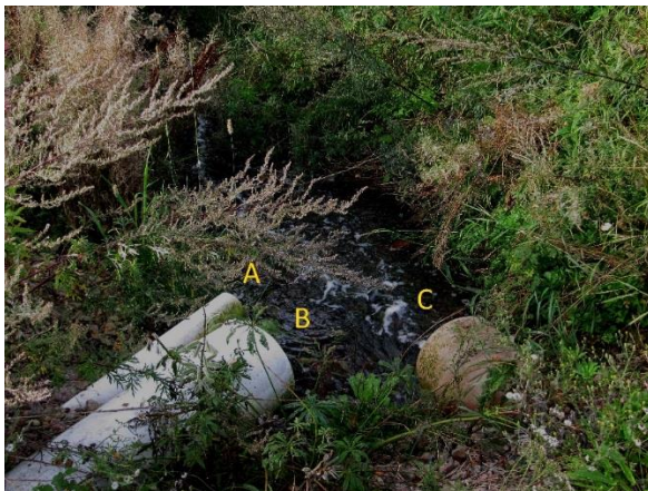
Kuva 2.10. Purkuputket Parkanon jätevedenpuhdistamon tontilla. A) hulevesiputki, B) ohitusvesiputki, C) käsitellyn jäteveden purkuputki.
