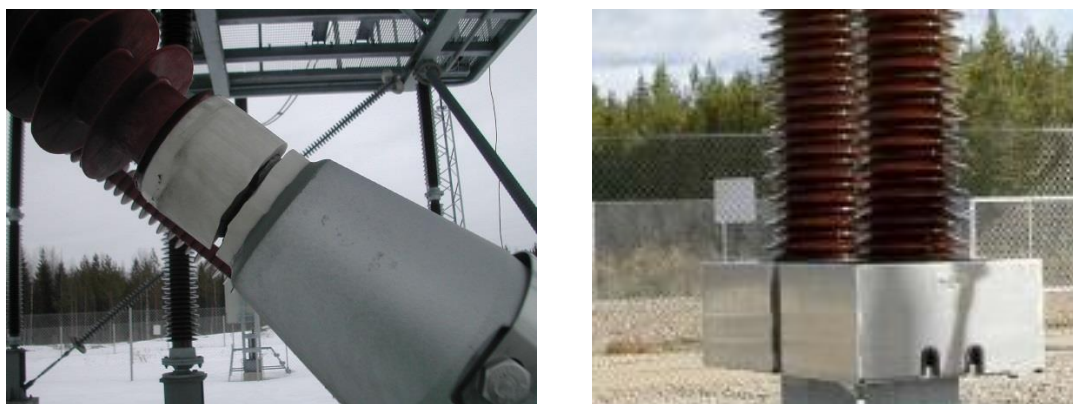
Kuva 7.1 Vasemmalla vioittunut komposiittieristeisen valopilarin posliininen liitokappale ja oikealla ehjä posliinieristeinen valopilari.
