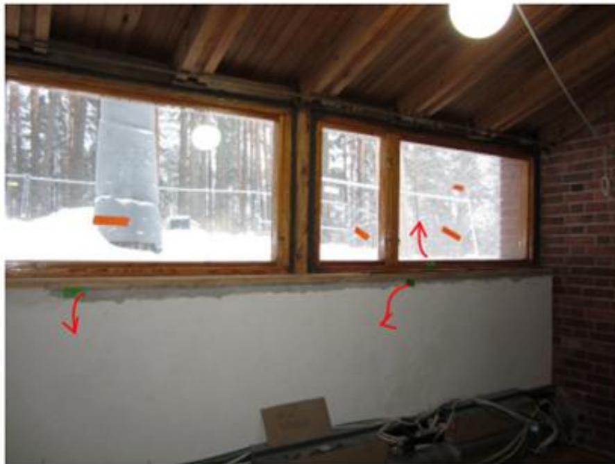
Kuva 29. Tilan 201 mittauksessa havaitut vuotokohdat
