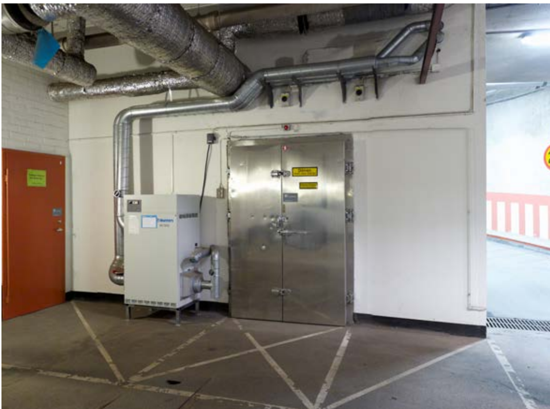
SISÄÄNKÄYNTI PARKKIHALLISTA. OVEN VIERESSÄ ILMANKUIVAIN.
