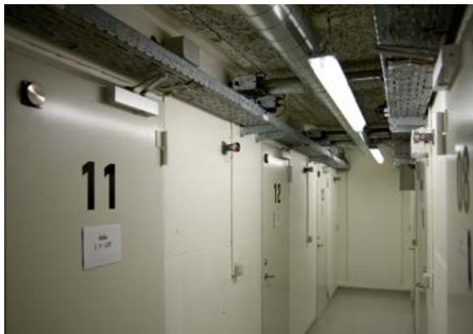
SIILOJEN OVISSA ON SÄHKÖ- LAUKAISTAVAT AUKIPTOLAITTEET.
