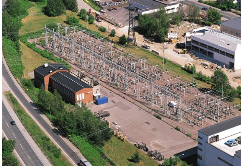
Kuva 3. HSV:n Hertoniemen sähköasema, jossa on 110 kV:n ulkokytkinlaitos [11].
