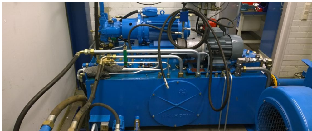
Kuva 4.4. Hydraulioöljysäiliö ja osa apukoneikkoa.
