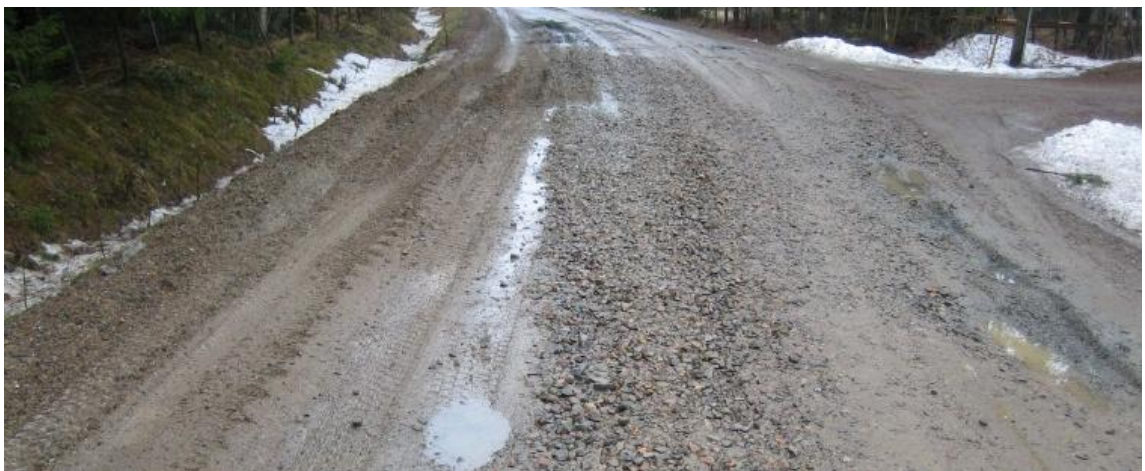
Kuva 6.1 Pihthisalmentien Kuntokartoituksessa havaittu routavaurio (Kuva: Tero Jokinen)
