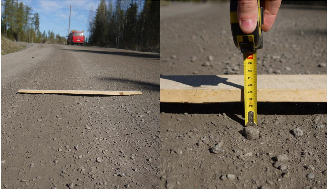
Kuva 7.9 Tieosuudella tyypillisesti mutkien sisäkaarteissa havaittua urautumista, joka syntyy liikenteen ja renkaiden kuluttavasta vaikutuksesta tien kulutuskerrokseen (Mäkinen, 2013)
