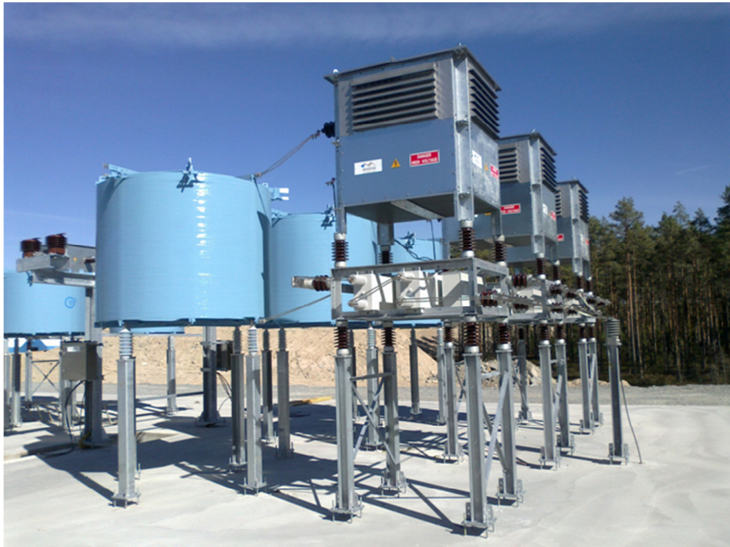
Kuva 6. Toisen asteen laajakaistasuodatin, viritystaajuus 650 Hz, kompensointiteho 6.2 Mvar mitoitusjännite 37,97 kV, nimellistaajuus 50 Hz. Valmistaja Alstom Grid Oy.
