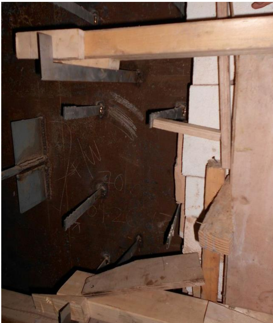
Kuva 3.7. Puutteellisten muottien tuentojen ongelmia, avoimen päädyn tuennan viritys (AG-Port Oy).
