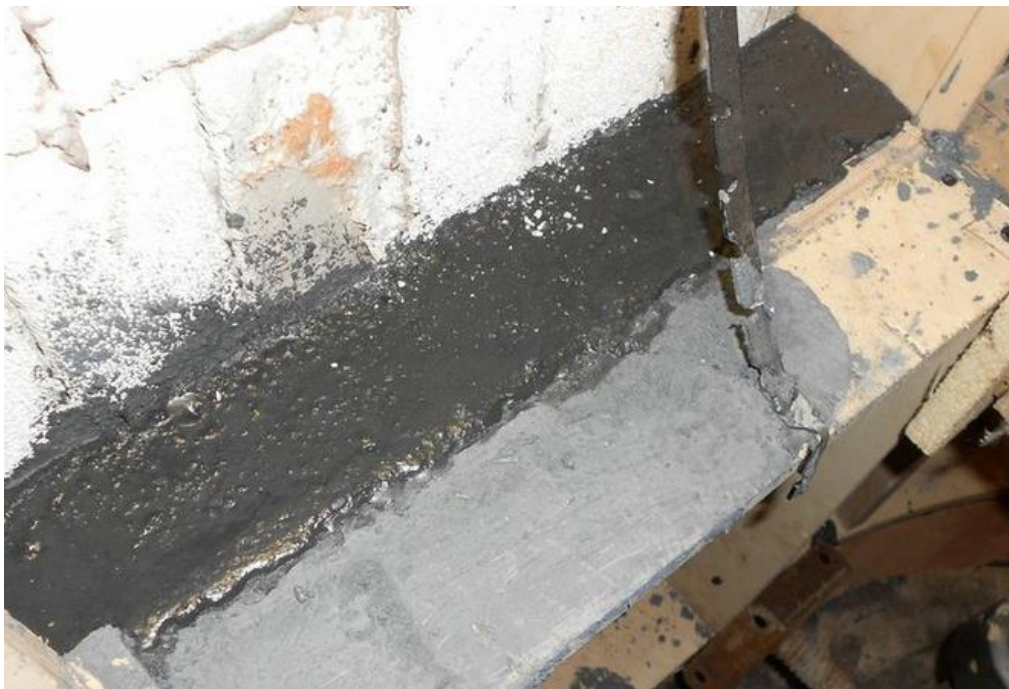
Kuva 3.8. Viimeistelemättömän valupinnan ongelmaa (AG-Port Oy).
