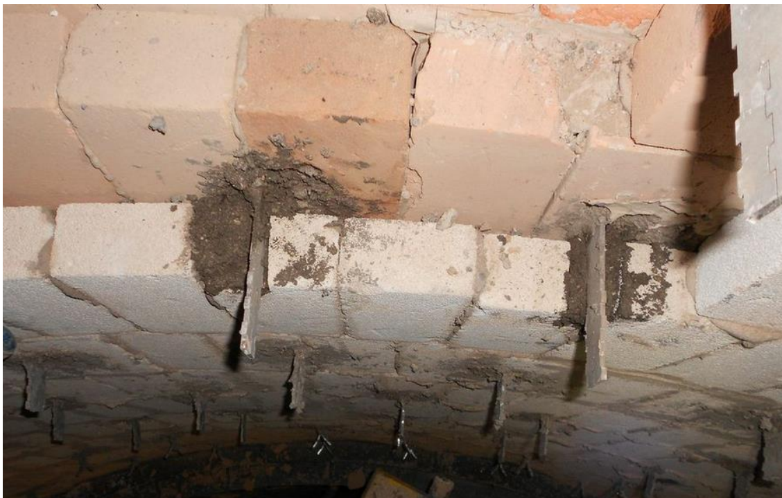
Kuva 3.5. Eristystiilien asennuksen laatuvirheitä (AG-Port Oy).
