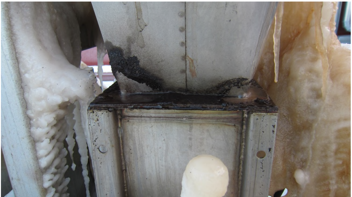
Kuva 18. 05WPLTO02 laitteiston vuotokohtia.
