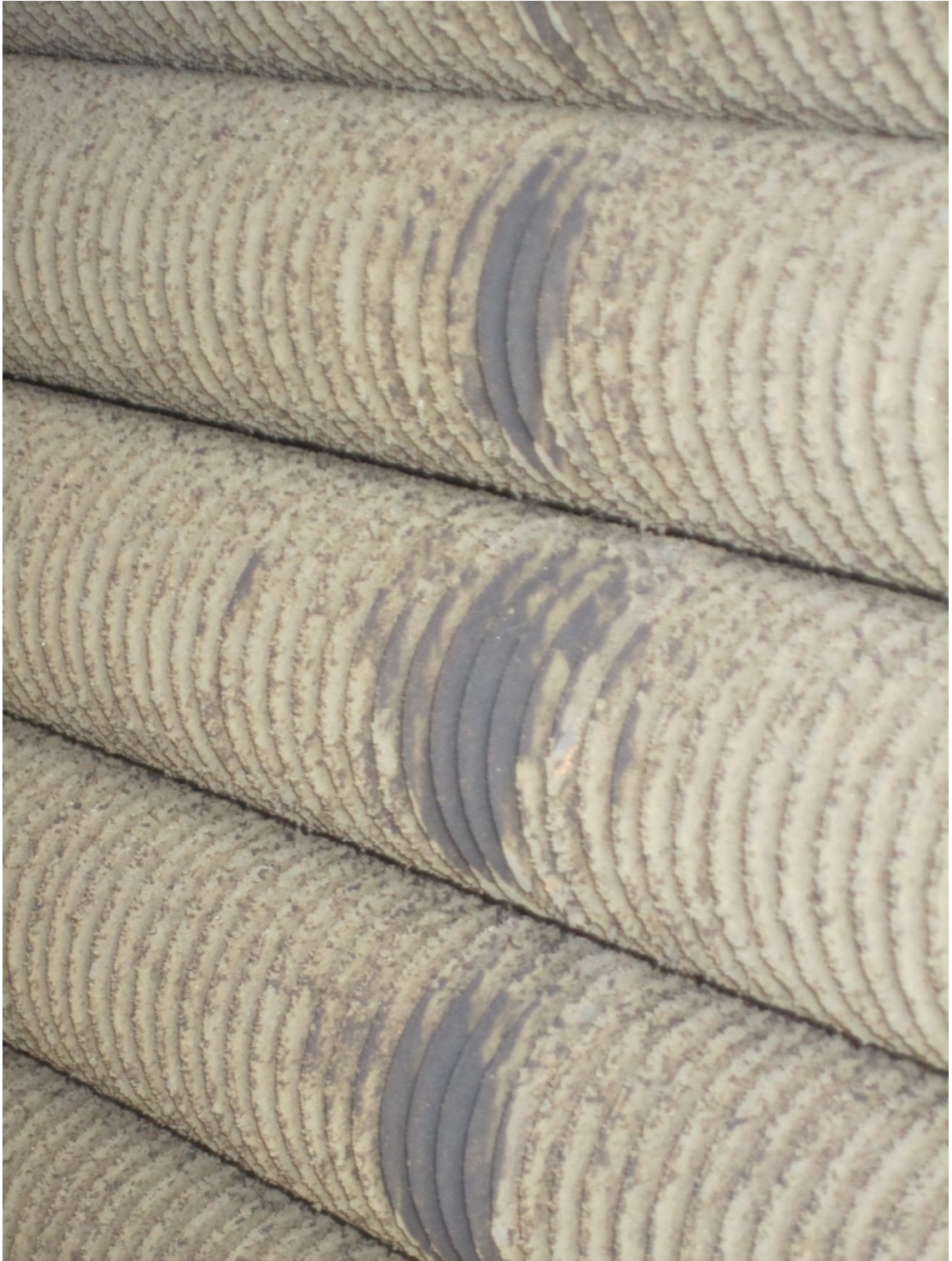
Kuva 23. Pintamaalauslinjan lämmöntalteenottopatteri likaiselta puolelta.
