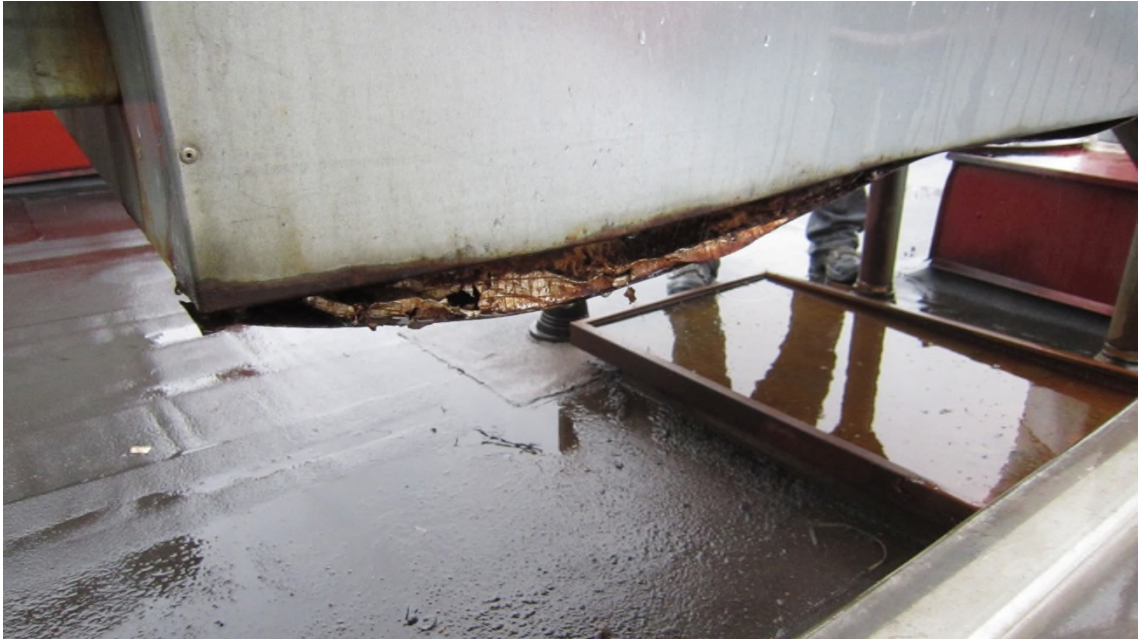
Kuva 17. 05WPLTO02 laitteistosta ulosvuotavan veden aiheuttamia vaurioita.
