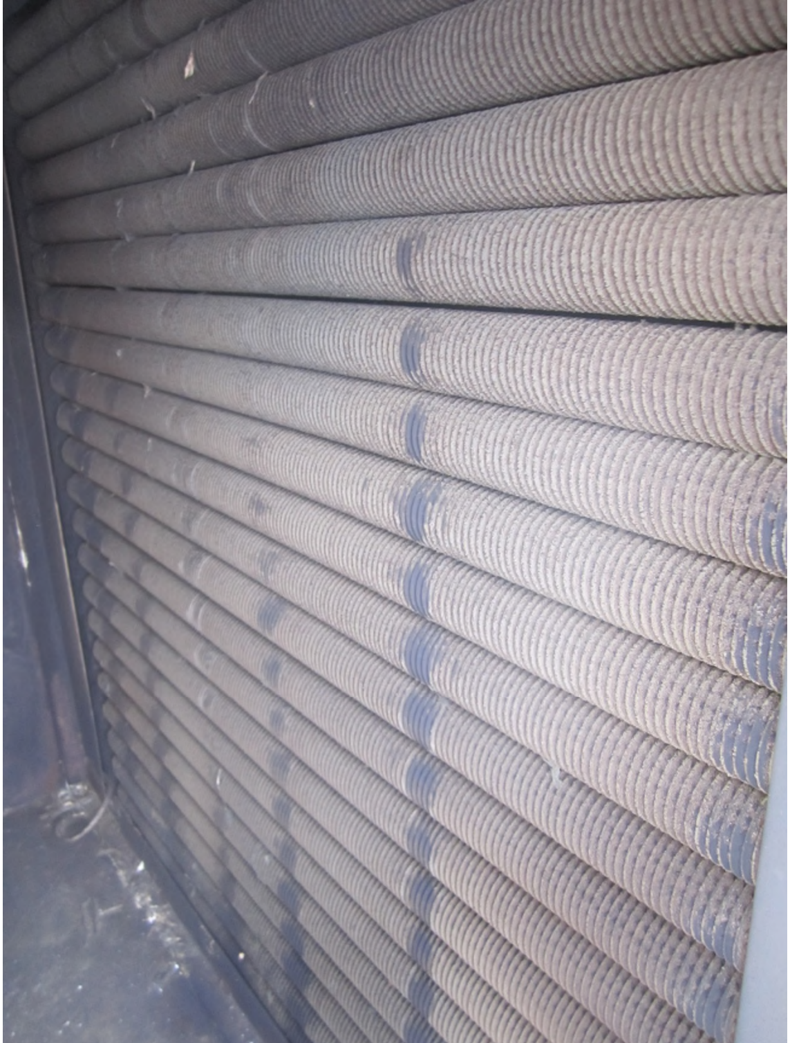
Kuva 22. Pintamaalauslinjan lämmöntalteenottopatteri likaiselta puolelta.
