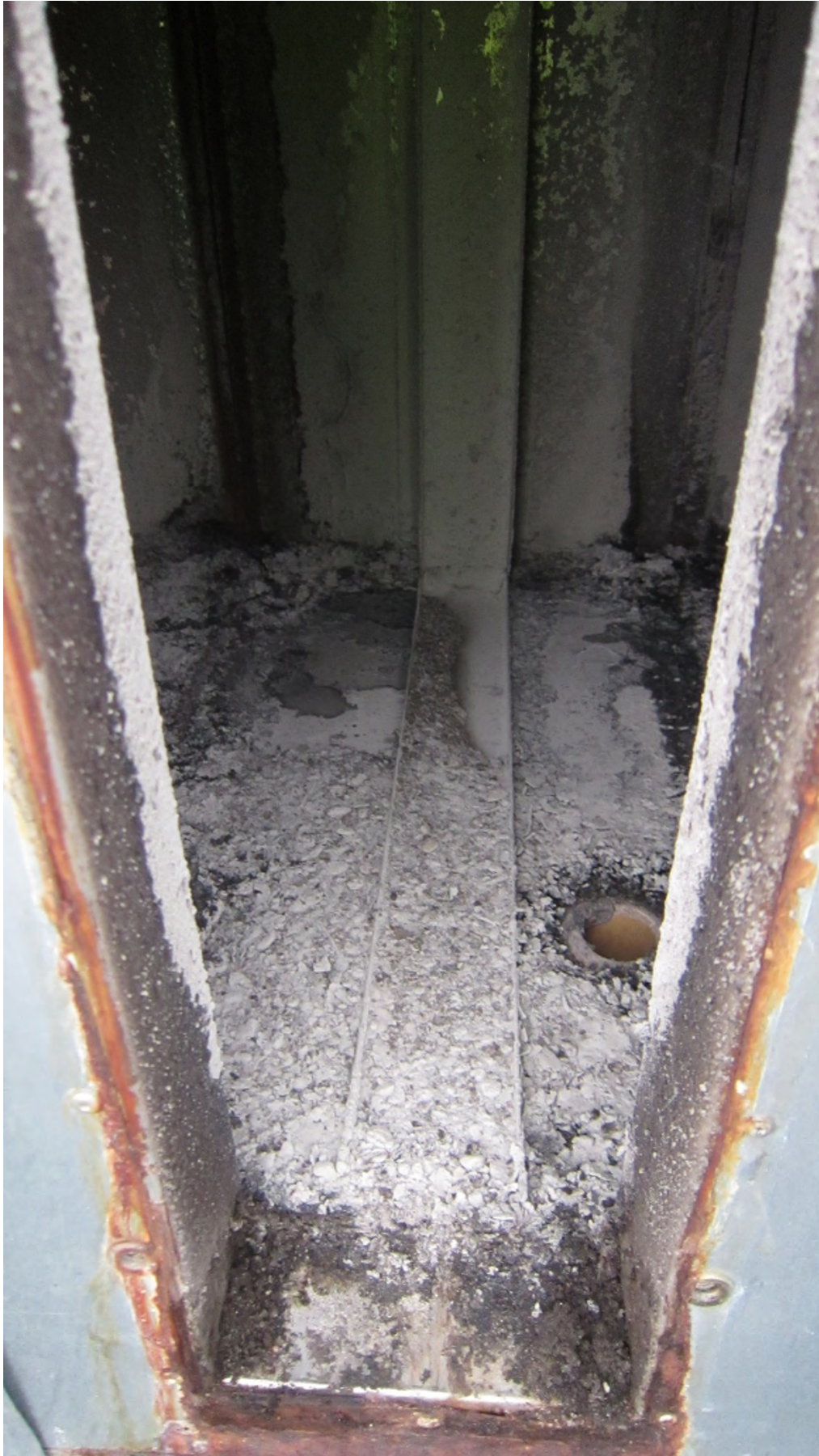
Kuva 14. 05WPLTO02 huoltotila ennen LTO-patteria.
