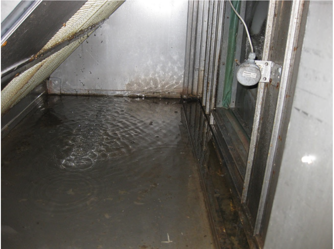
Kuva 2. Ilmanvaihtokoneen ristivirtalämmöntalteenoton jättöpuoli.
