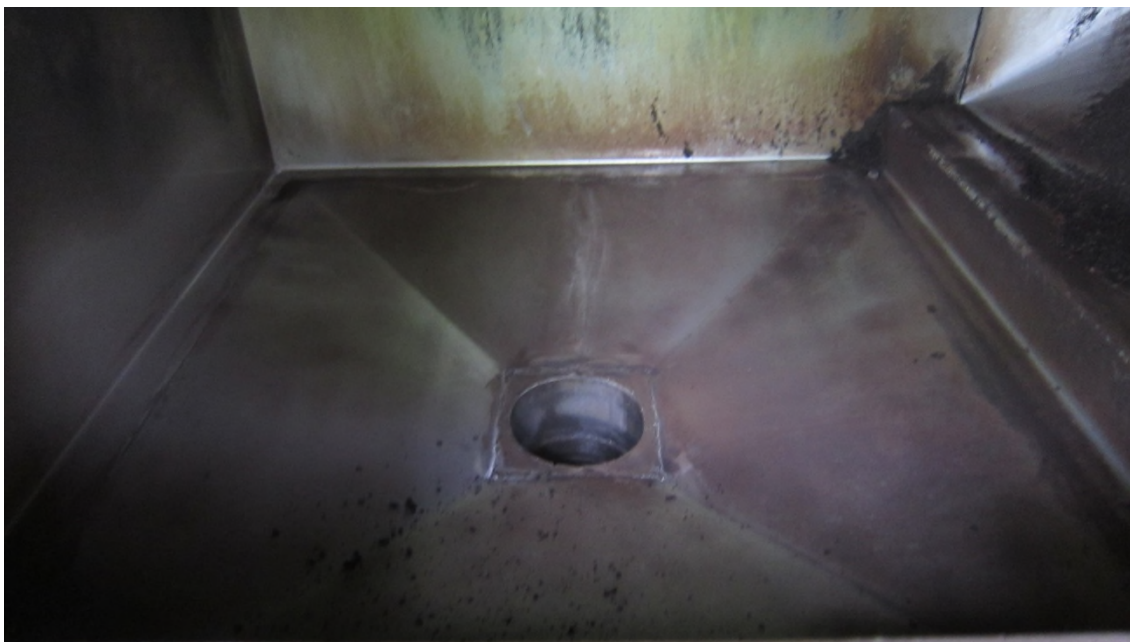
Kuva 12. 05WPLTO01 LTO patterin alapuolella oleva pesuvesikammio.
