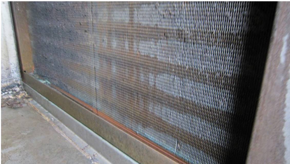
Kuva 19. Laatikkopesukoneen lämmöntalteenottopatteri likaiselta puolelta.
