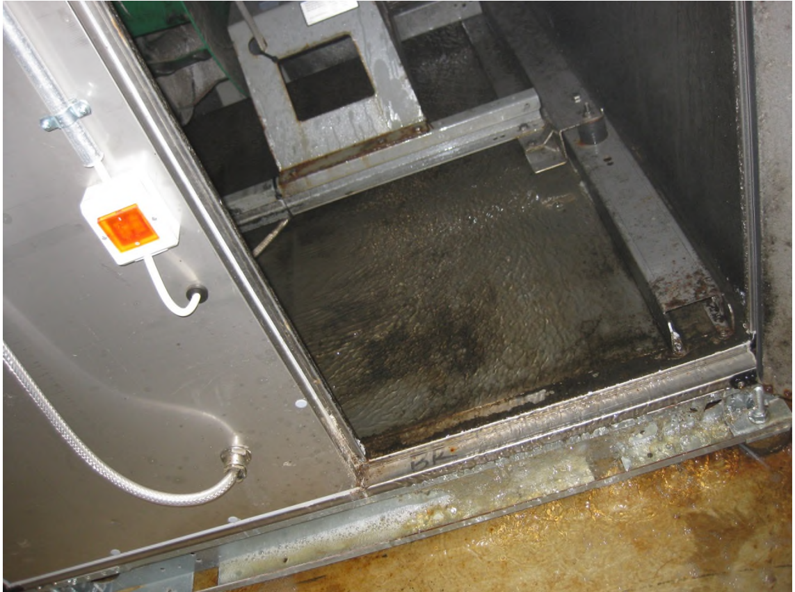
Kuva 3. Ilmanvaihtokoneen poistopuhaltimen kammio.
