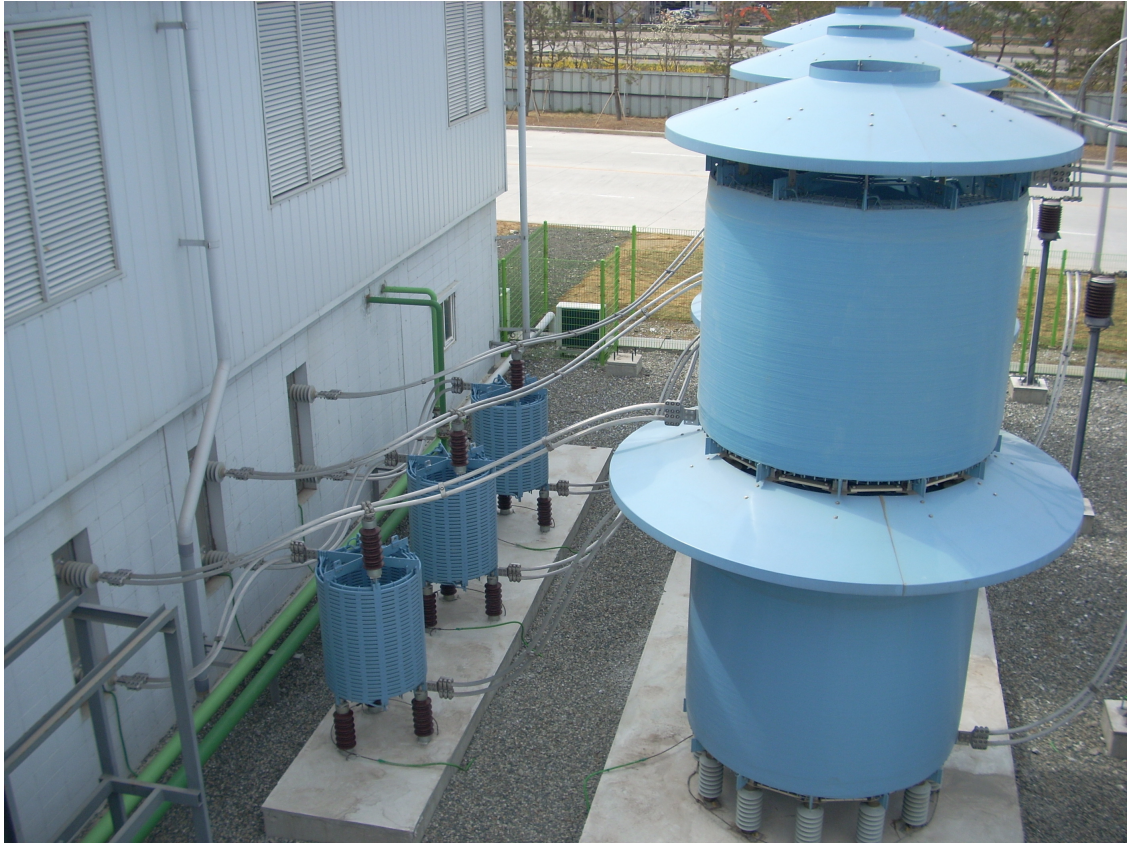
Kuva 13. Kuristin varustettuna pölysuojalla.
