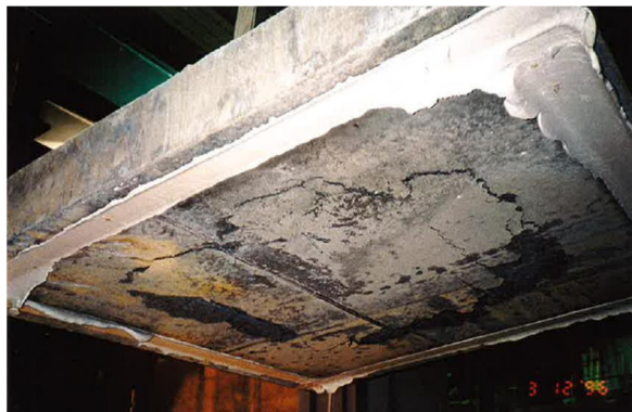
Kuva 4.12 Laatan 2 alapintaan syntyneet vauriot lävistymisen jälkeen [7, s. liite 6]
