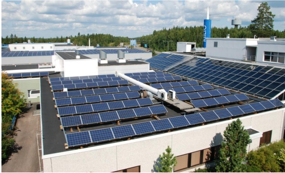
Kuva 4.4. Kiilto Oy:n tehtaan katoilla oleva aurinkosähköjärjestelmä [46].
