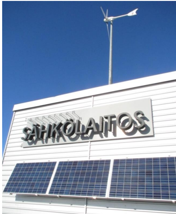
Kuva 4.26. Nekalan lämpökeskuksen seinällä olevia aurinkopaneeleita.
