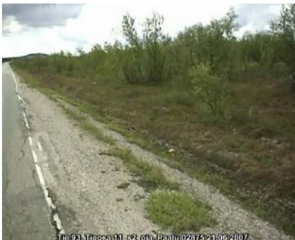
Kuva 18. Sivukaltevassa maastossa sijaitsevan tien sivuoja on tukkeutunut, minkä takia tienreunan päällyste on alkanut halkeilemaan. (Saarenketo 2009, s.18.)
