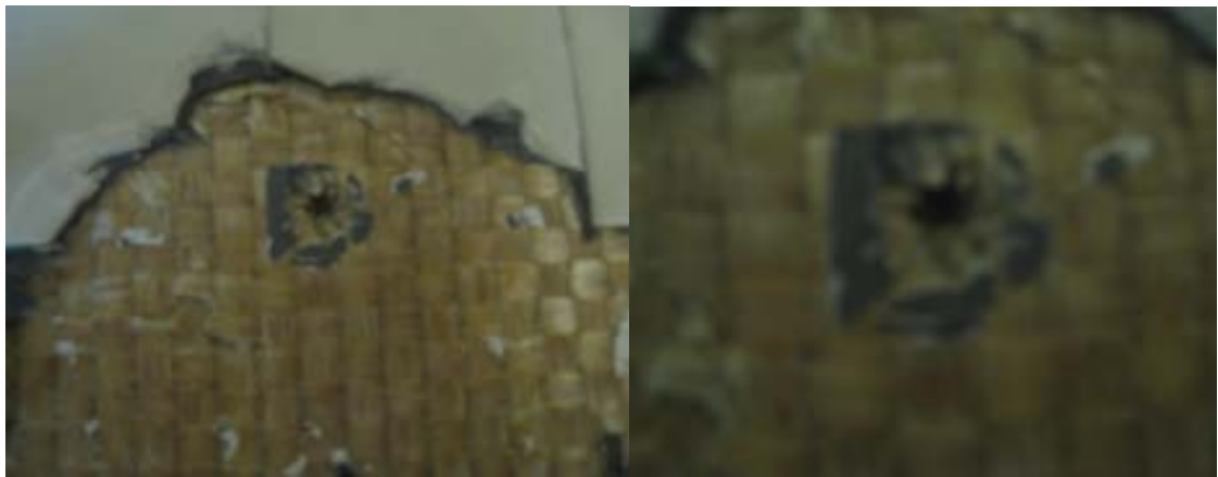
Kuva 9.14. Keraamin reunaan muodostuneet vauriot ja luodinreikä.
