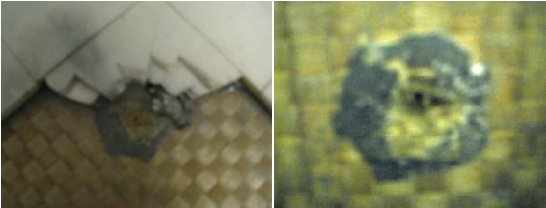
Kuva 9.6. Keraamipinnan alle syntyneet vauriot.
