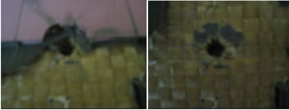
Kuva 9.12. Keraamilaatan reuna osumakohdassa ja luodinreikä.
