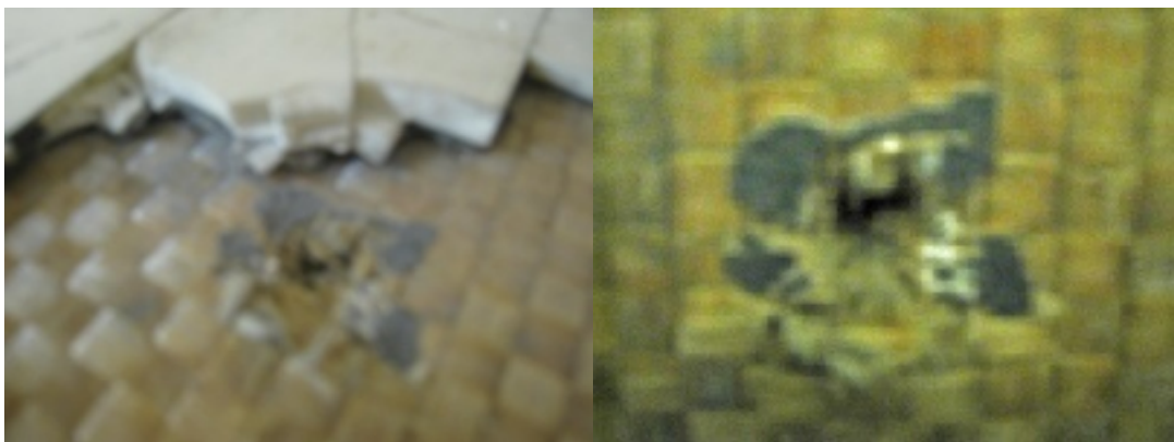
Kuva 9.10. Vasemmalla keraamilaattaan iskun aiheuttamat vauriot ja oikealla luodinreikä sekä sidosvauriot.
