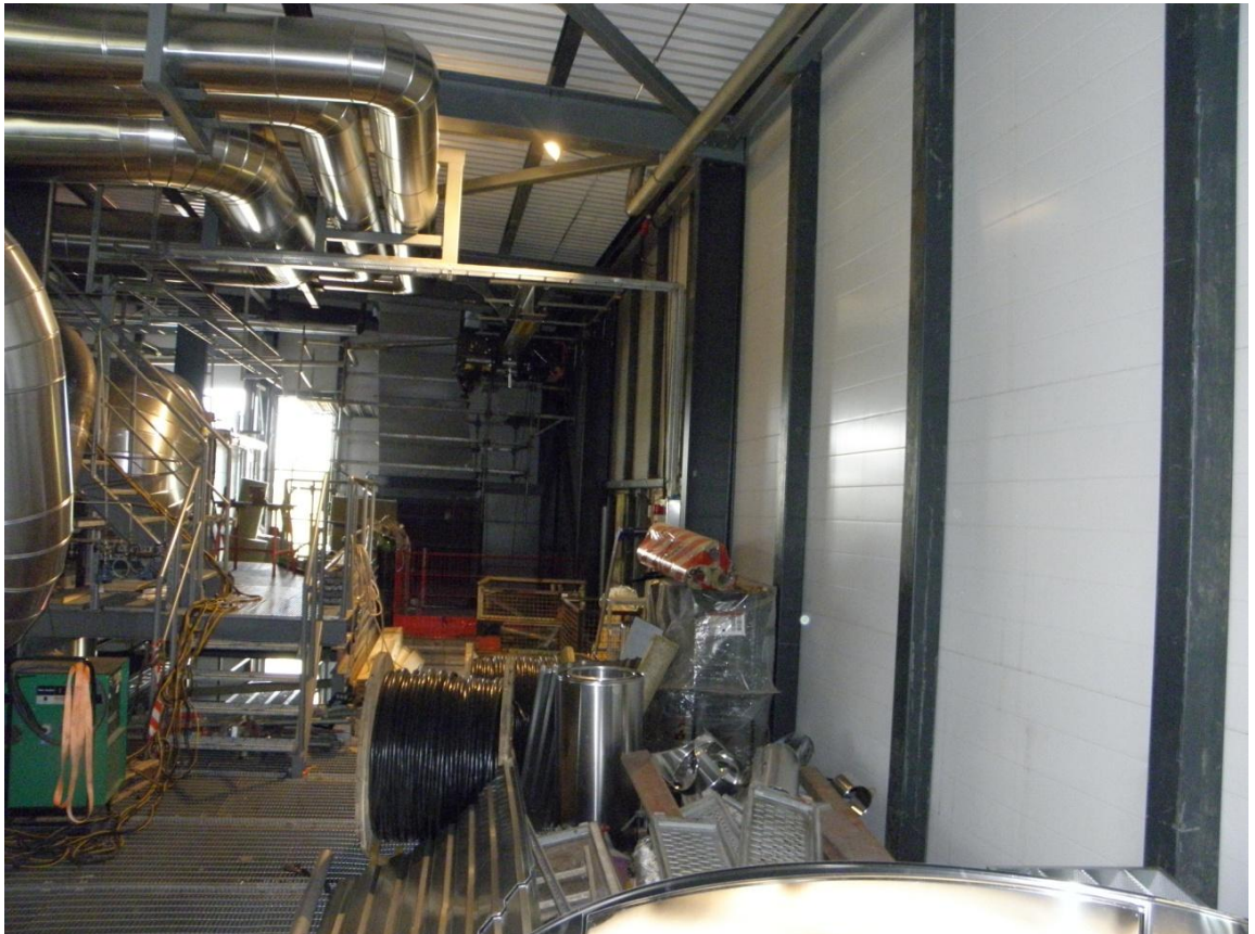
Kuva 26. Teline- ja muuta materiaalia varastoituna kattilahuoneeseen.
