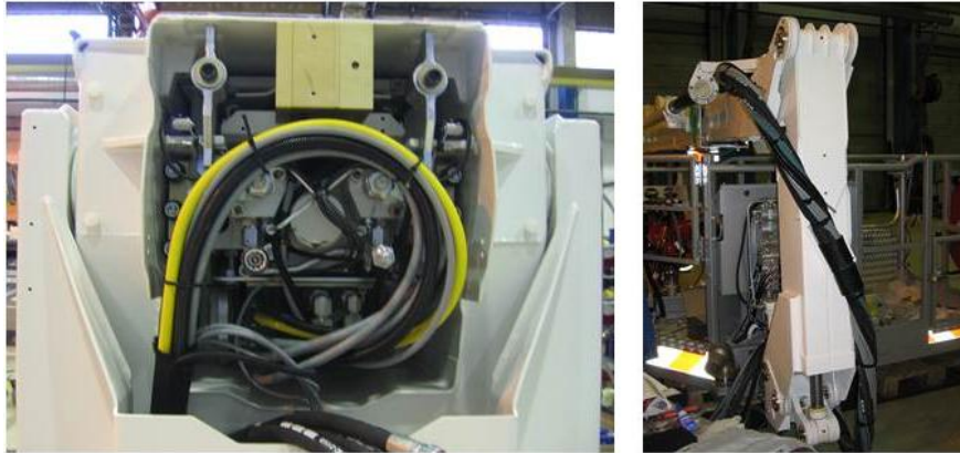
Kuva 7.5. Kaapelivientejä laitteen eri osissa.
