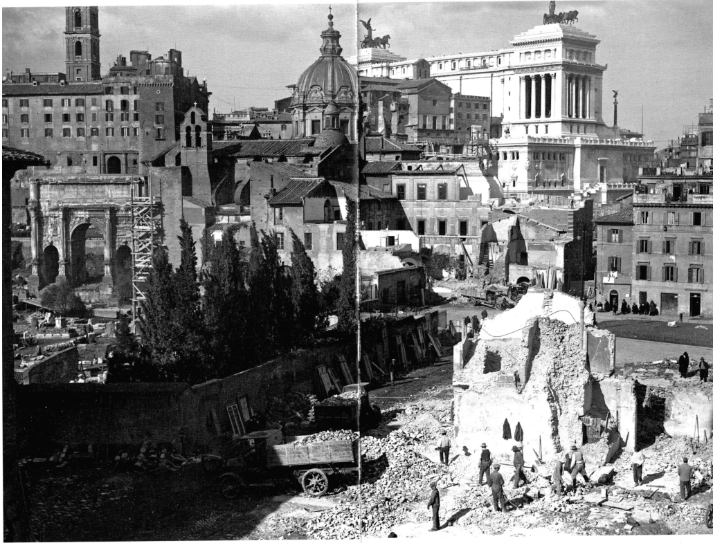
Kuva 29. Augustuksen foorumin päällä olleiden asuinrakennusten purkutyöt suoritettiin kiireellä Via dell'Imperon rakennustöiden yhteydessä helmikuussa 1932. Lähde: Insolera 2002, s. 149.
