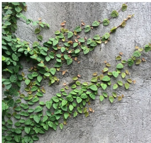
Kuva 3. Kosteutta sitova kasvi betonirakenteen pinnassa (Capili 2025).
