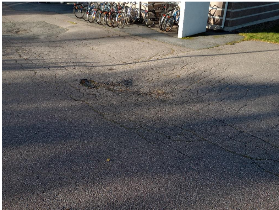
Kuva 6. Routanousun aiheuttamaa päällystevauriota kerrostalon piha-alueella
