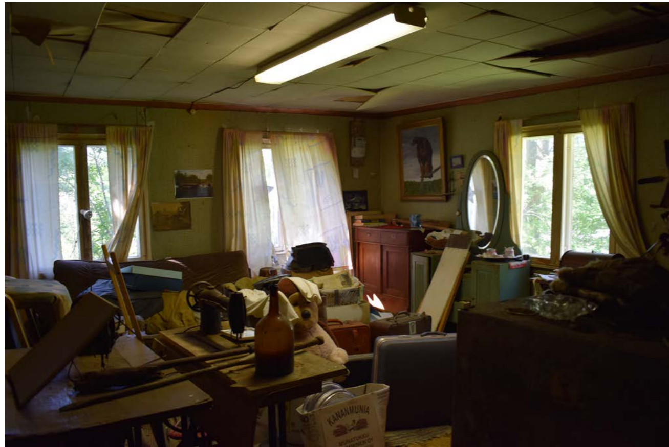
Kuva 73. Tupa. Katon puukuitulevyt ovat päässeet paikoittain tippumaan. (Paavilainen, 2023)
