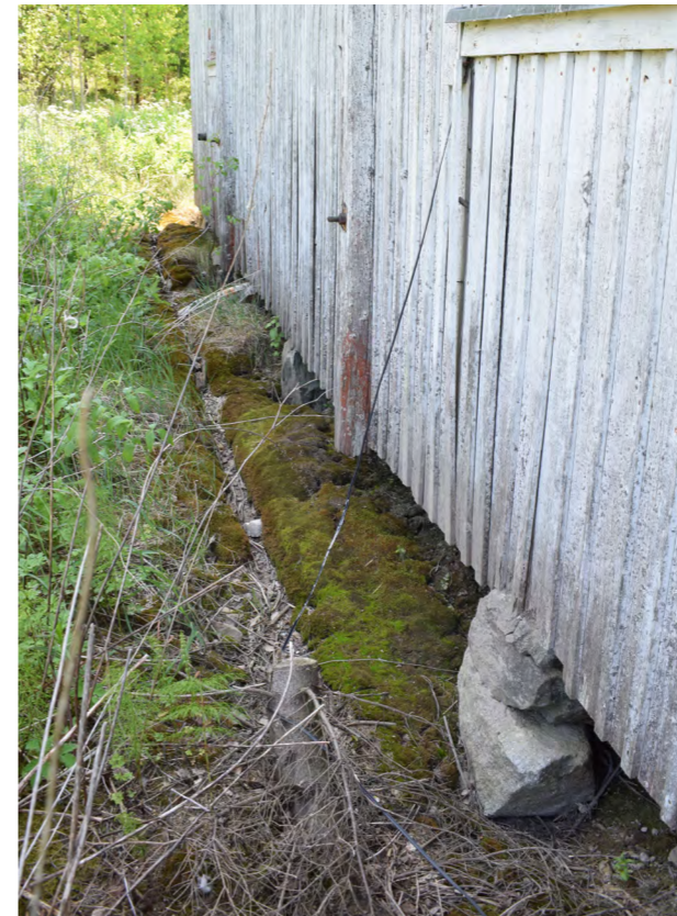
Kuva 138. Talo on perustettu luonnonkivien päälle, minkä vuoksi talo on liikkunut roudan vaikutuksesta. (Paavilainen, 2023)
