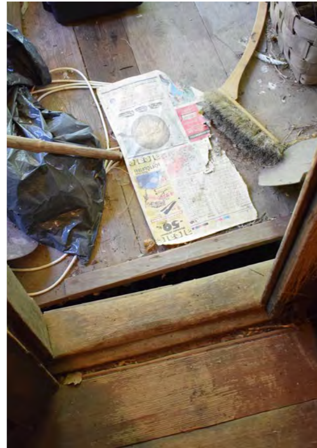
Kuva 81. Kuisti on liikkunut eri tahtiin kuin muu talo, minkä vuoksi väliin on muodostunut rako. (Paavilainen, 2023)
