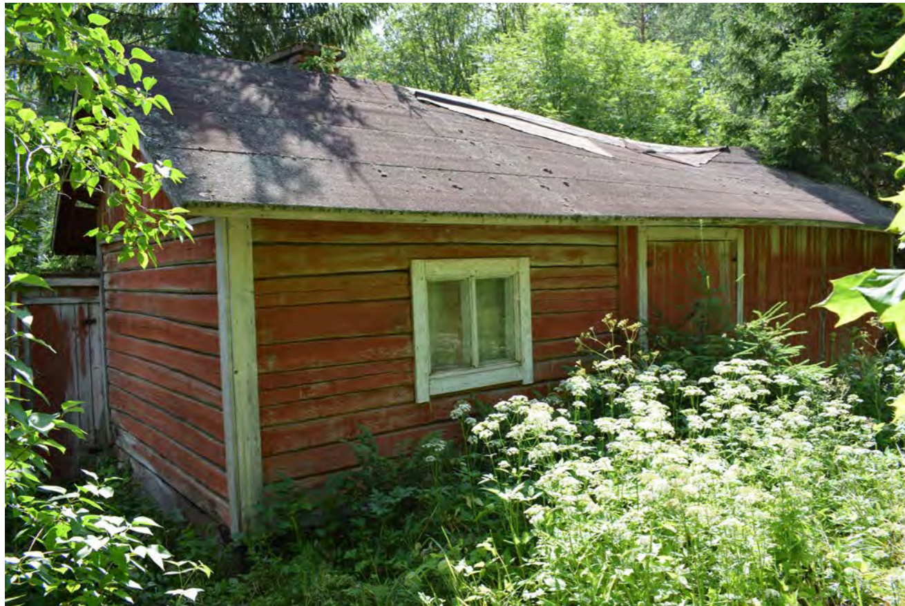
Kuva 209. Navetta muutettiin 1970-luvulla saunaksi. Katto on romahtanut sisään vuoden 2010 paikkeilla. (Paavilainen, 2023)
