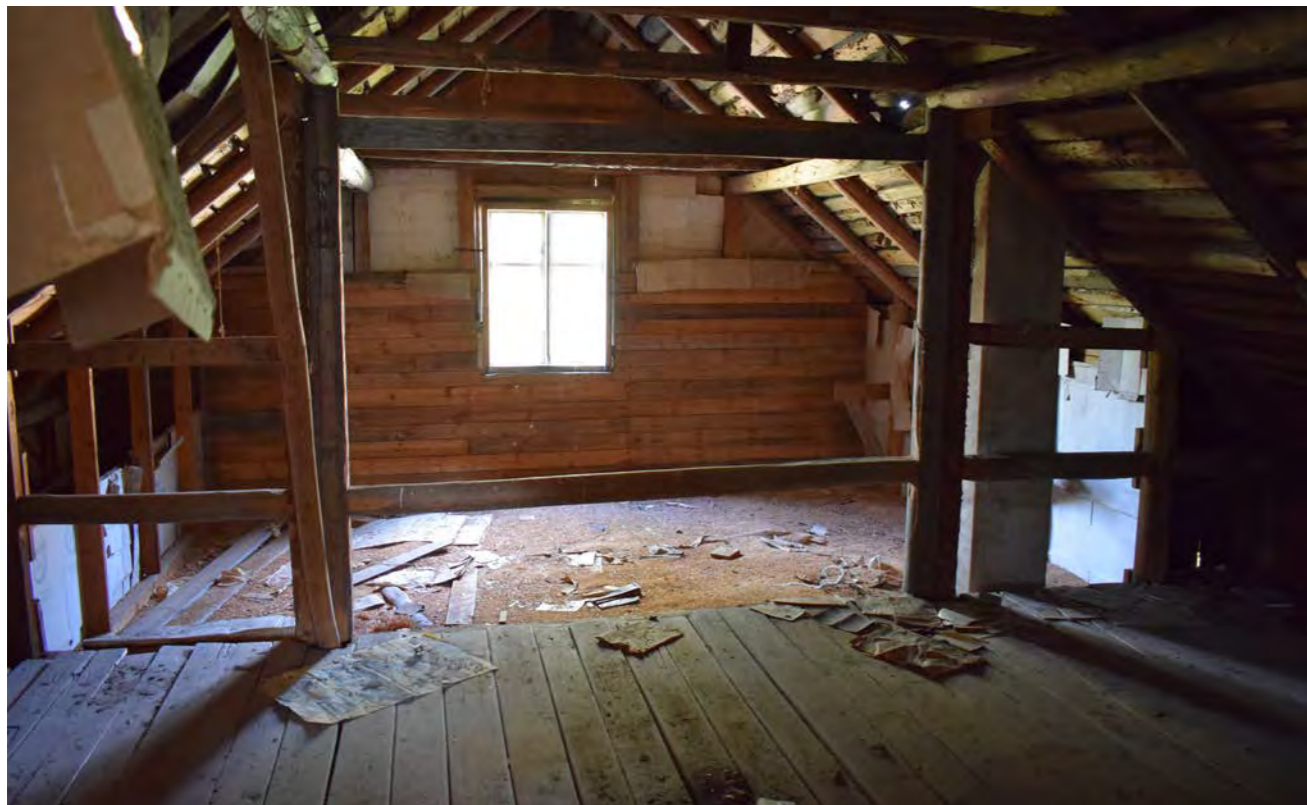
Kuva 315. Ullakko on asuinhuonetta lukuun ottamatta eristämätöntä vinttitilaa. Laajennoksen päälle ei ole edes tehty lattiaa. (Paavilainen, 2023)
