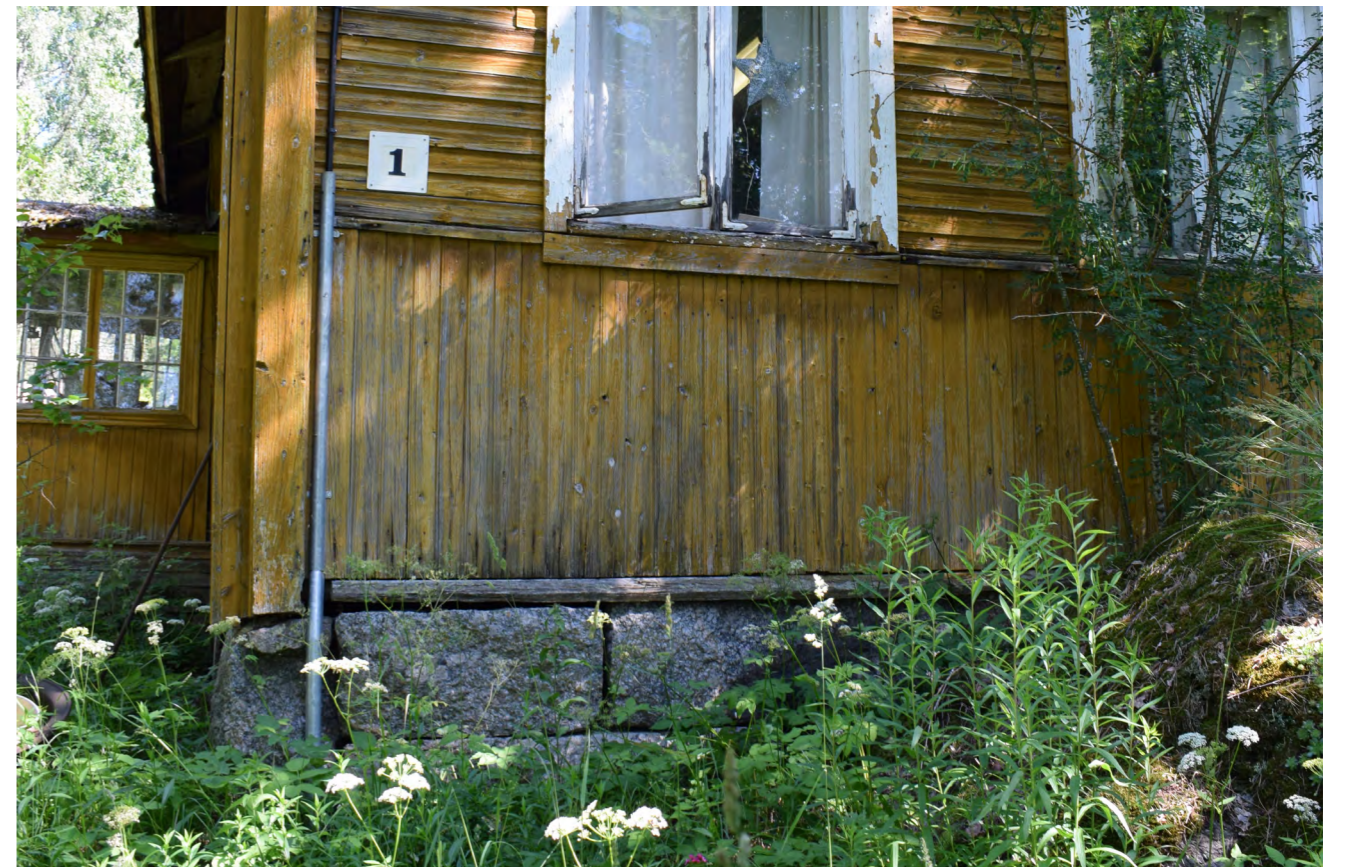
Kuva 72. Perustukset tehty lohkokivistä. Vuoraus on maalattu 1960-luvulla samoihin aikoihin, kun ikkunat on uusittu. (Paavilainen, 2023)
