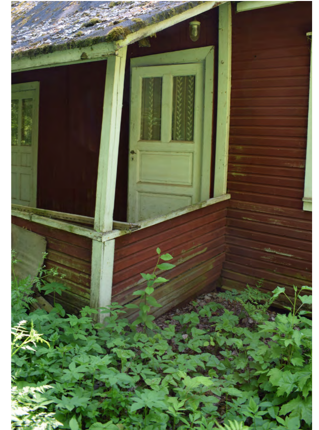
Kuva 56. Veranta on päässyt vajoamaan. (Paavilainen, 2023)
