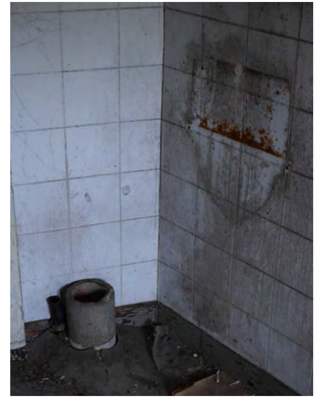
Kuva 310. Keittiön seinässä on jälki lavuaarista ja lattiasta törröttää viemäriputki. Taloon voinut tulla vesi, mutta siitä ei ole varmuutta. (Paavilainen, 2023)
