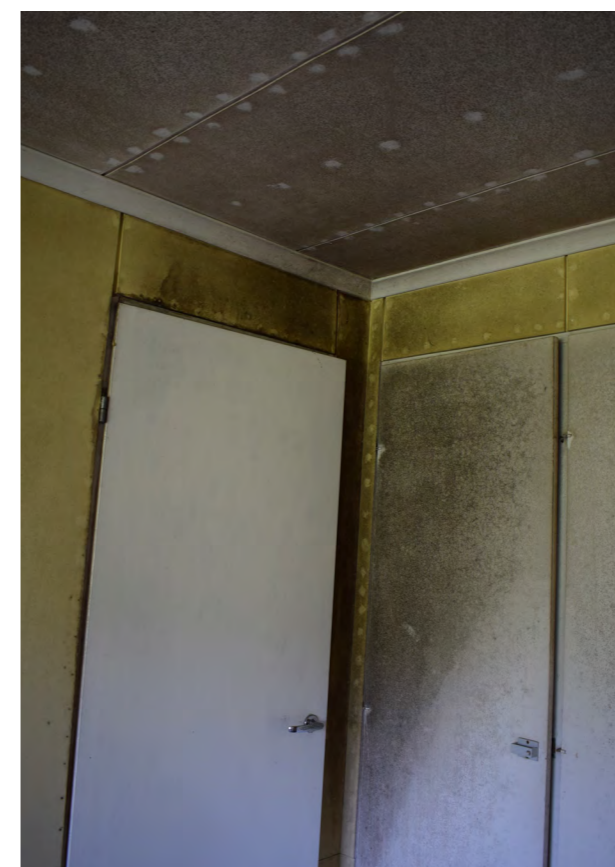
Kuva 448. Eristämättömän ullakon ovesta on levinnyt kosteutta ja pintahometta. (Paavilainen, 2023)
