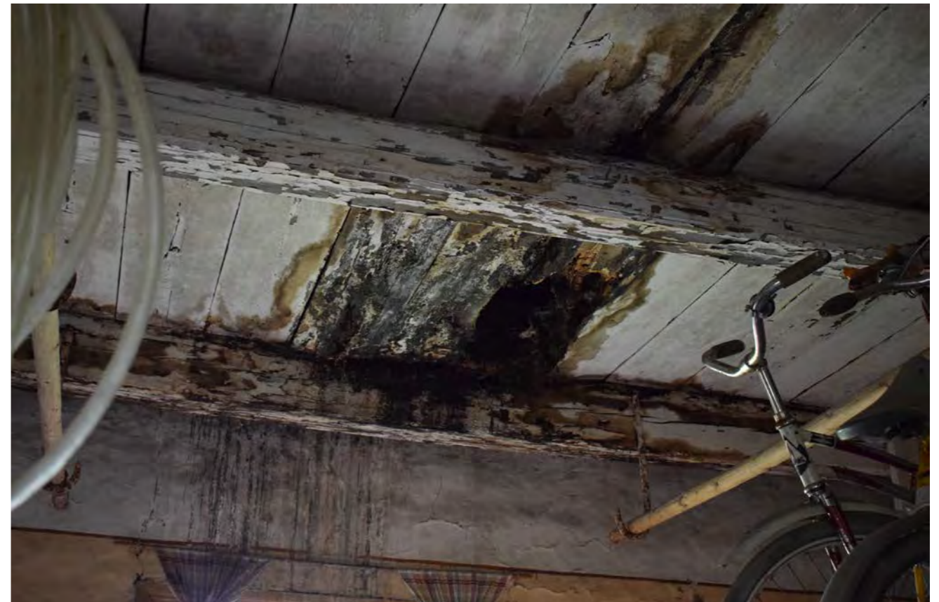
Kuvat 39. Yläpuolisen kuvan vauriokohta sisältä. Vesi on lahottanut puuta niin, että alakattoon on joutunut reikä. Reiän kautta vesi on tippunut lattialle, johon on myös aiheutunut lahovauriota. (Paavilainen, 2023)
