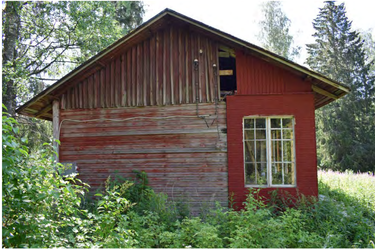
Kuva 384. Asuinrakennus pohjoisesta. Eteisen päädyssä ollut ulko-ovi on siirretty piha puolelle. Julkisivulaudoitus on eteisen kohdalta uusittu remontin aikana vuonna 2019. (Paavilainen, 2023)
