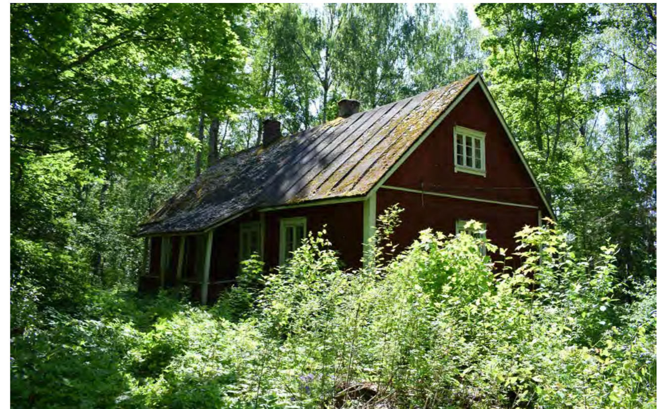
Kuva 57. Tontti on käyttämättömyyden myötä jäänyt hoitamatta, ja puut ja pensaat ovat päässeet valtaamaan tontin. Koillisen puoleinen katon lape on sammaloitunut, eikä aina pääse kuivumaan sateiden välissä. (Paavilainen, 2023)
