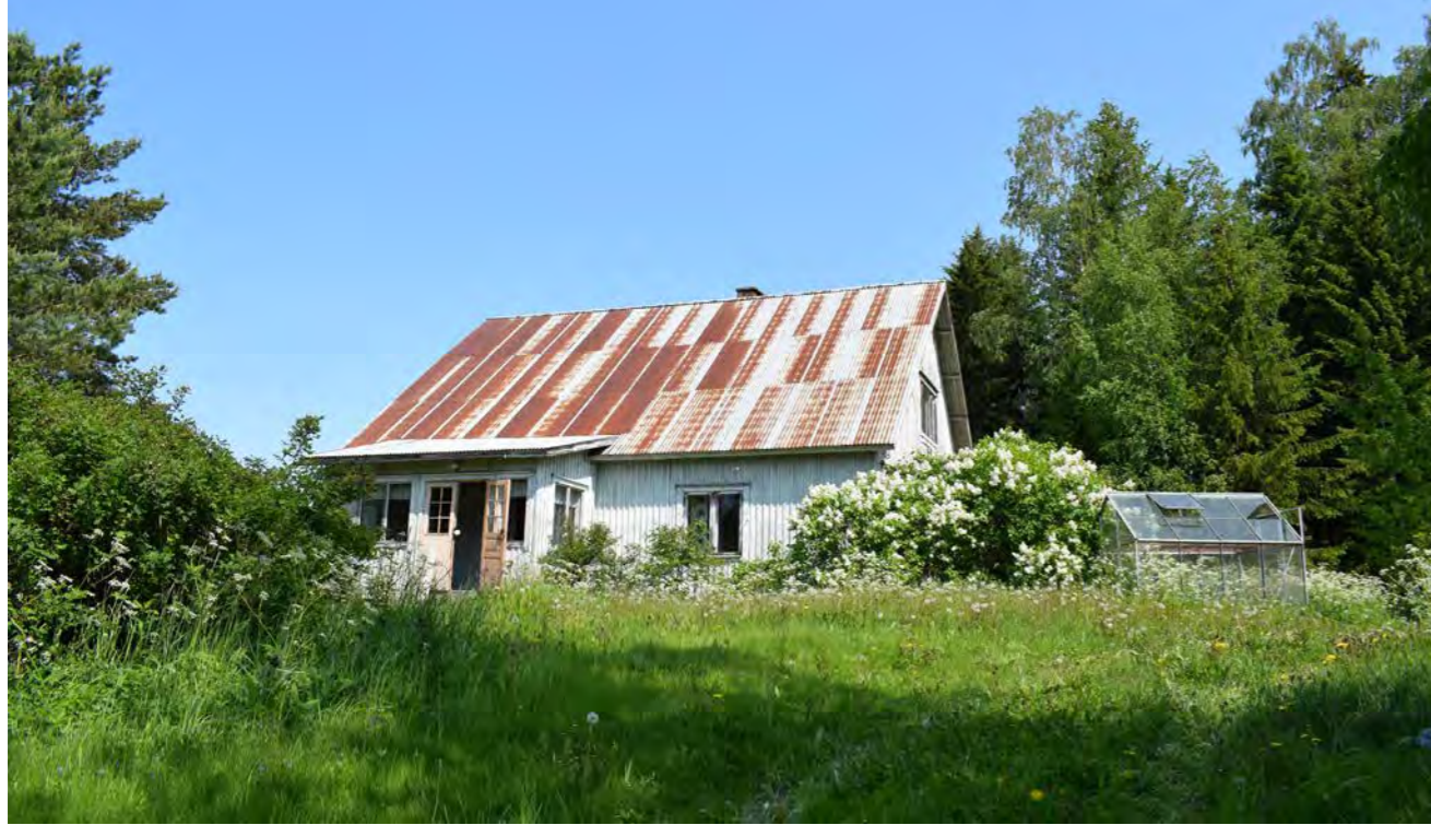
Kuva 135. Hailun talo Murronkulmantieltä.. Talo sijaitsee pienen mäen päällä. Lounaan puolelta aaltopeltikatto on päässyt ruostumaan pahemmin kuin koillisen puolelta. (Paavilainen, 2023)
