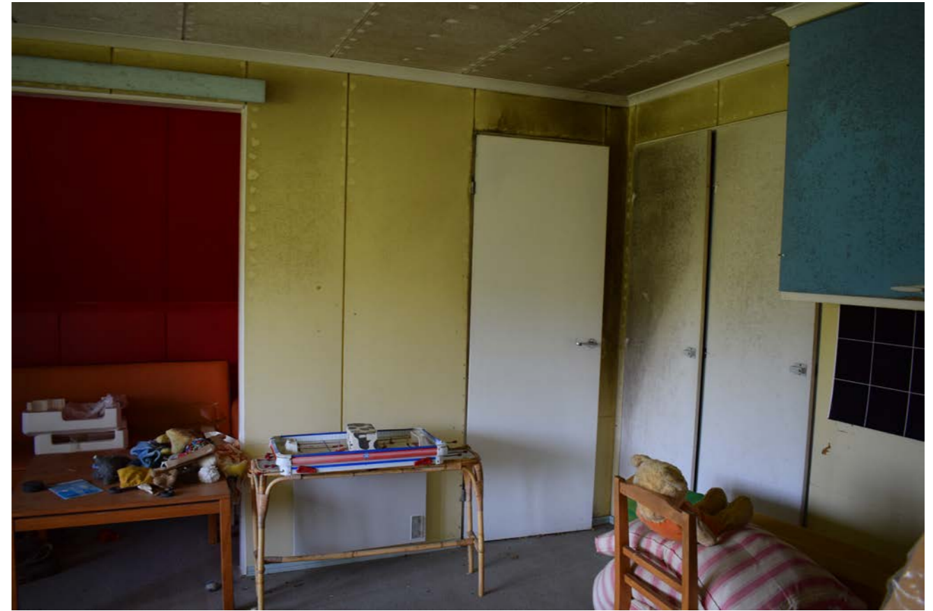
Kuva 146. Ullakon toisessa makuuhuoneessa on alkovi. Huoneeseen on levinnyt mustaa hometta varaston oven kautta. (Paavilainen, 2023)
