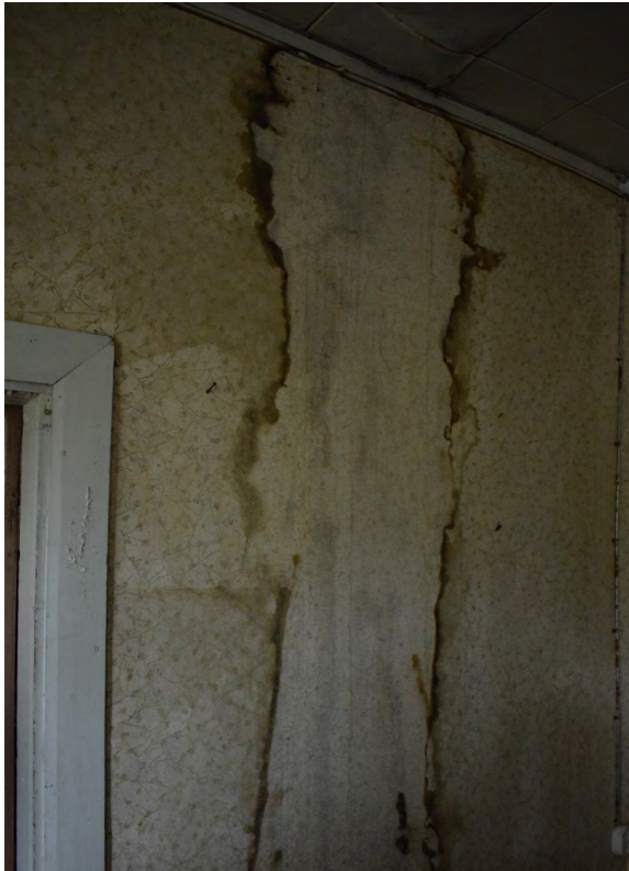
Kuva 37. Jälkiä vuodoista on myös kamarin ja pirtin välisessä seinässä. Kuva kamarin puolelta. Savirappaus on lohkeillut toisella puolella seinää. (Paavilainen, 2023)
