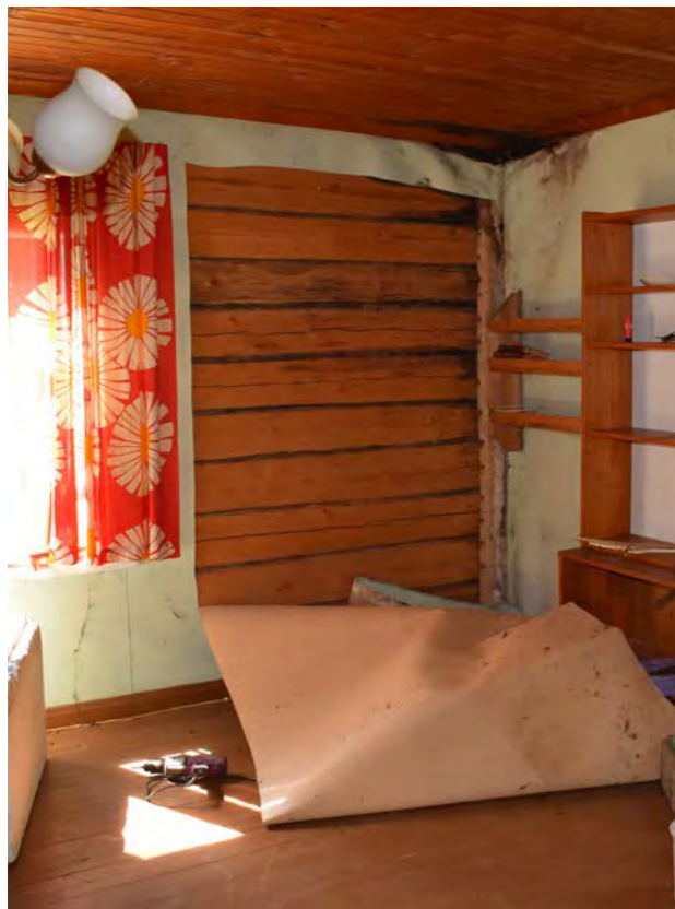
Kuva 162. Pirtin seinästä pinkopahvia on avattu. Kulmauksessa puu on päässyt tummumaan. (Paavilainen, 2023)
