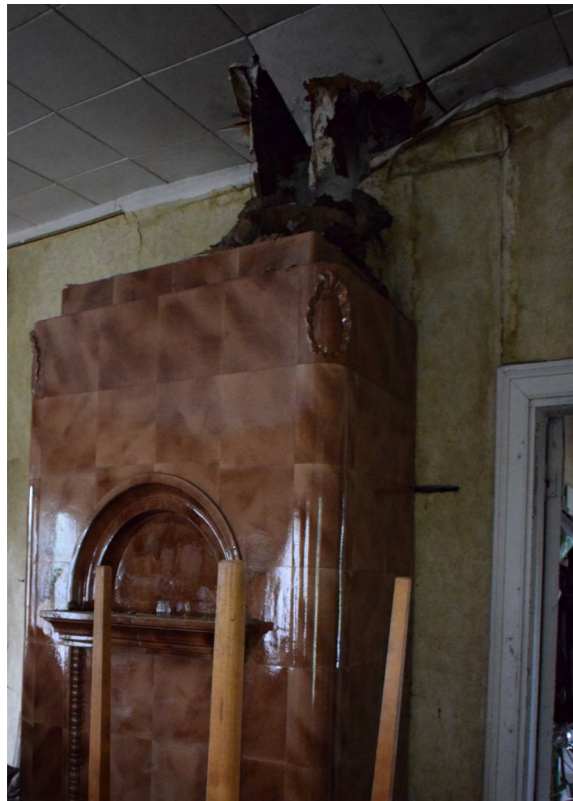
Kuva 36. Salin puoleinen piippu on vuotanut. Samanlainen, mutta pienempi, vaurio on myös kamarin puolella. (Paavilainen, 2023)
