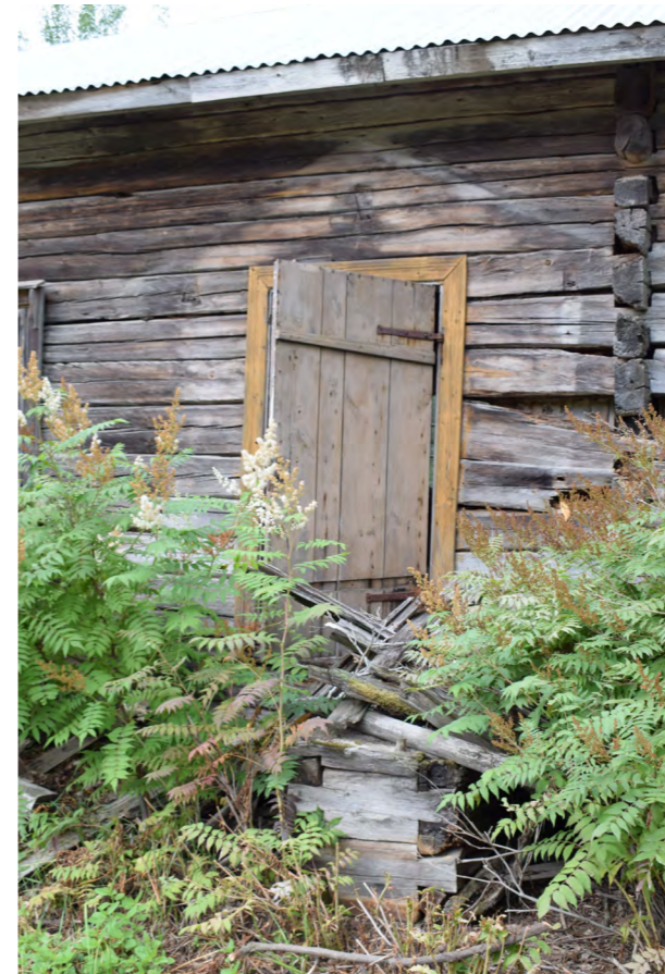
Kuva 340. Pitkällä sivulla on ollut kuisti. Kuistin muodon voi havainnoida ulkoseinän värieroista. (Paavilainen, 2023)
