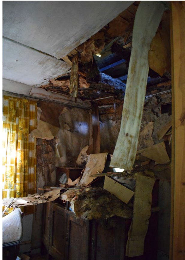
Kuva 251. Makuuhuoneessa katto on osittain romahtanut sen jälkeen, kun lunta oli satanut alakaton päälle. (Paavilainen, 2023)
