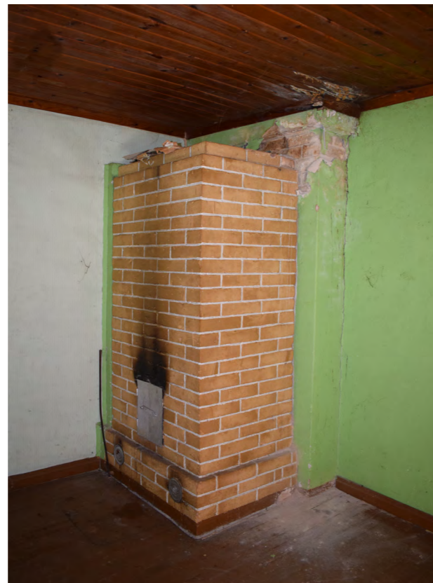
Kuva 163. Pirtin tiilinen takka. Muurin rappaus on päässyt kosteuden takia varisemaan, ja alakatto lahoamaan. (Paavilainen, 2023)
