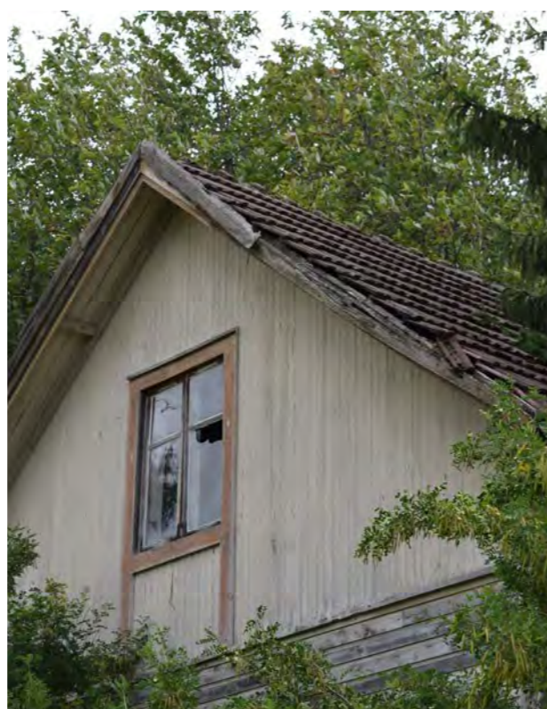
Kuva 303. Talon katto alkaa olla huonossa kunnossa. Savupiiput ovat tukkeentuneet naakkojen pesien takia. (Paavilainen, 2023)
