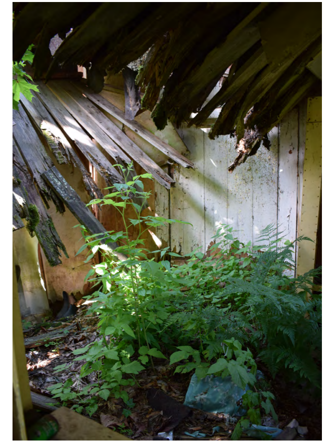
Kuva 201. Kuistin katto on romahtanut 2000-luvun alkupuolella. (Paavilainen, 2023)
