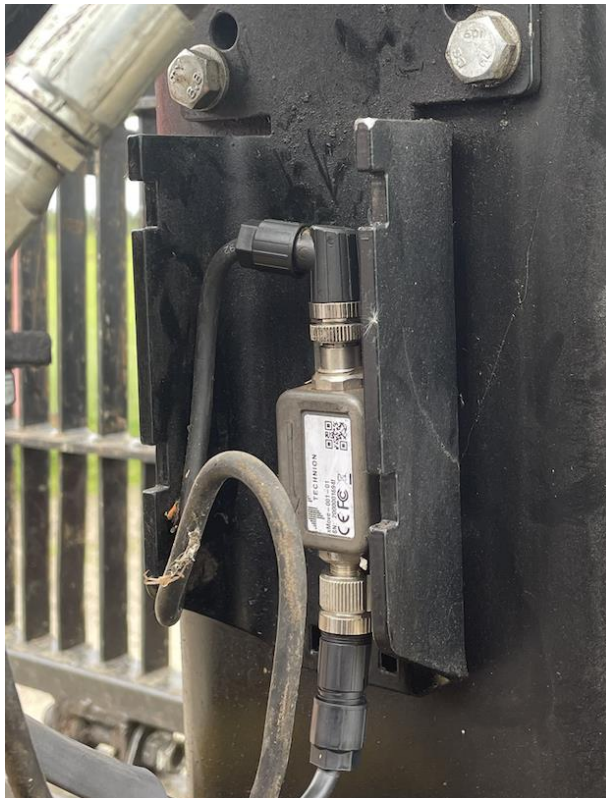
Kuva 20. Pystypilarin anturi liittimen vaihtamisen jälkeen, ylempi liitin vaihdettu
