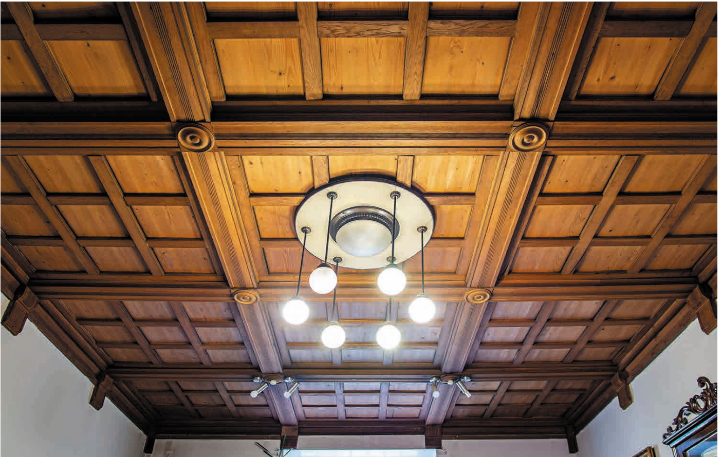
A Kattoa kosketaan ja pestään harvoin, joten se voi olla hyvä paikka käsittelemättömälle puulle. (EO)
