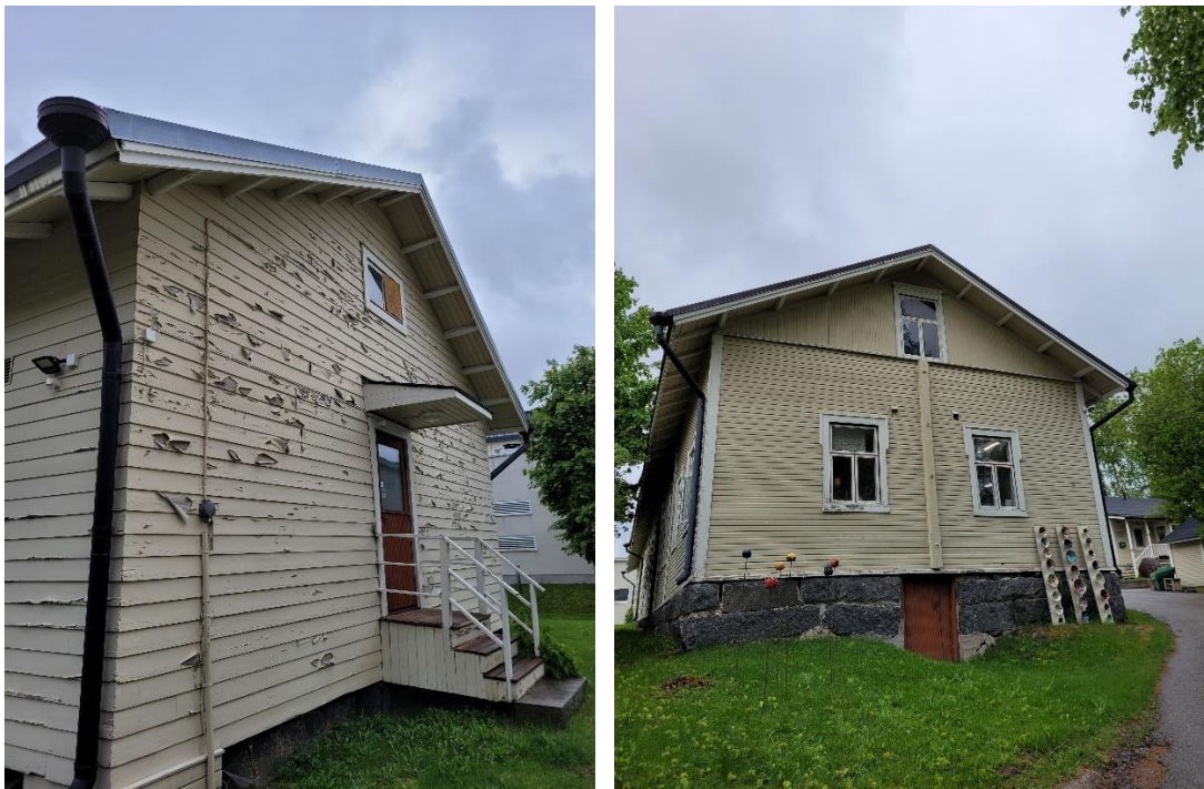
Kuva 15. Pitkäkatu 25:n rakennukset peruskorjauksen tarpeessa 26.5.2023
