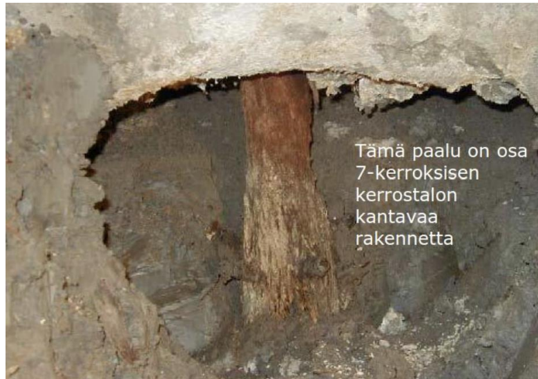
Kuva 10. Lahoava puupaalu kerrostalon perustuksissa. (Heikinheimo 2018)
