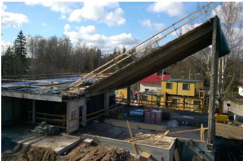
Kuva 33: Paloheinän kirkon odotettua suuremmat vauriot johtivat siihen, että kaikki sen runkoa lukuun ottamatta täytyi uusia. (Ailecon 2014)
