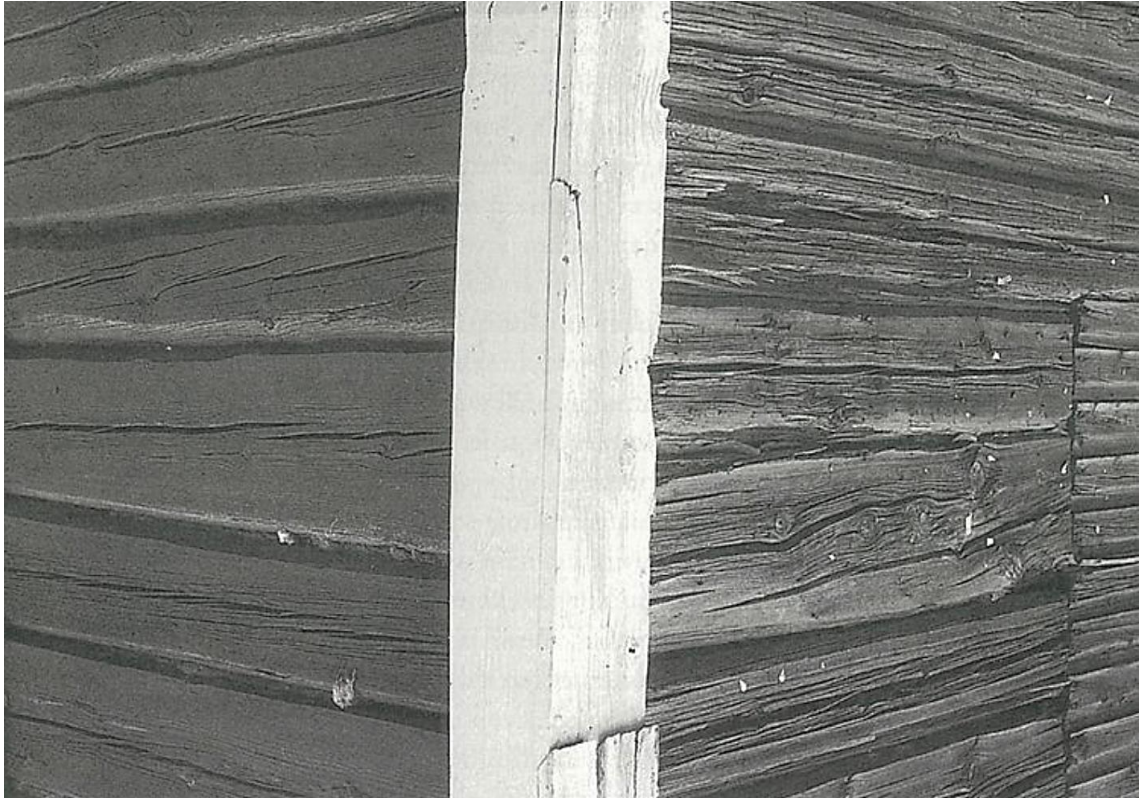
Kuva 8: 70 vuotta vanha hirsijulkisivu, jonka oikealla sivulla auringon aiheuttamaa halkeilua. Vasen sivu on ollut varjon puolella ja on siten paremmin säilynyt. Hirret on punamullalla käsitellyt. (Kaila 1997, 298)
