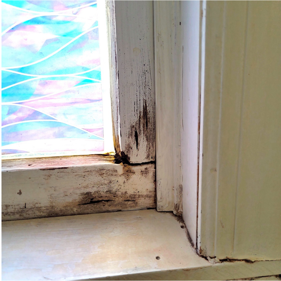
Kuva 13. Kosteusvaurioitunut kylpyhuoneen ikkunarakenne. (Carter 2022)
