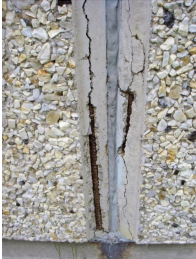
Kuva 9. Korroosioaurioita seinäelementin liitosalueella [32, s. 3]
