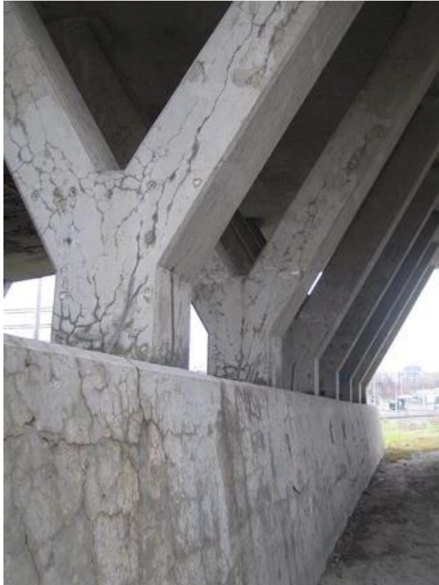
Kuva 6. Alkali-kiviainesreaktion vaikutukset siltarakenteessa [24]
