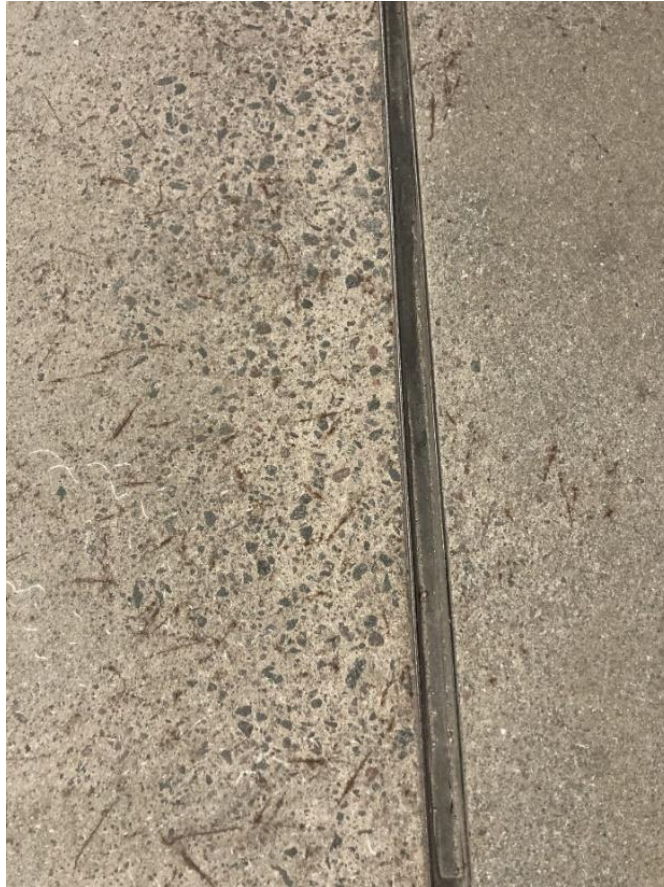
Kuva 8. Betonin pintakerroksen kuluminen [29]
