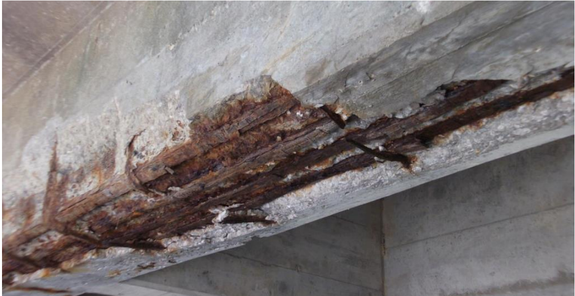
Kuva 5. Kloridikorroosion aiheuttamia vaurioita betonipalkissa [21]
