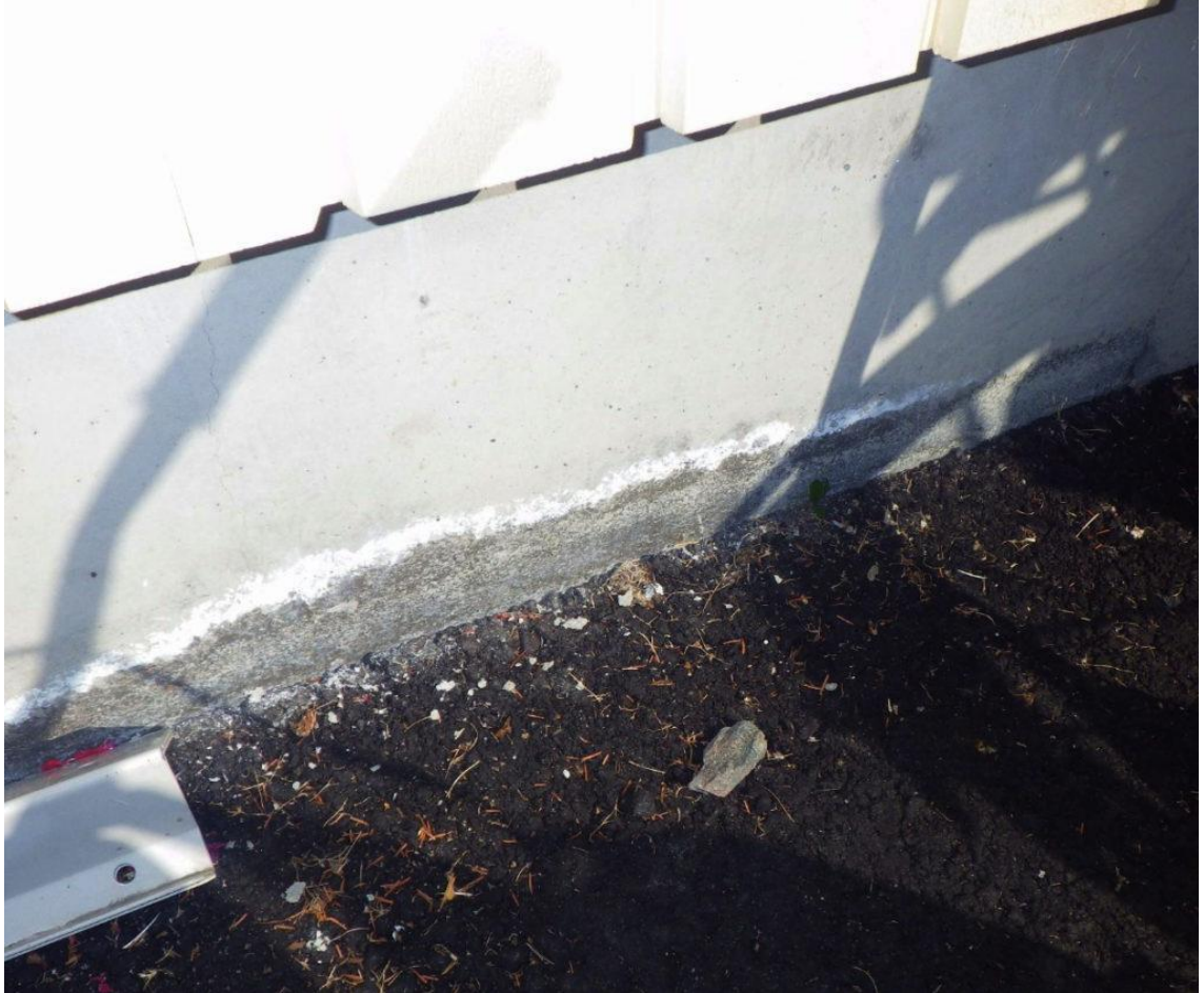
Kuva 3. Kalkkihärmää rakennuksen sokkelin pinnassa [17]
