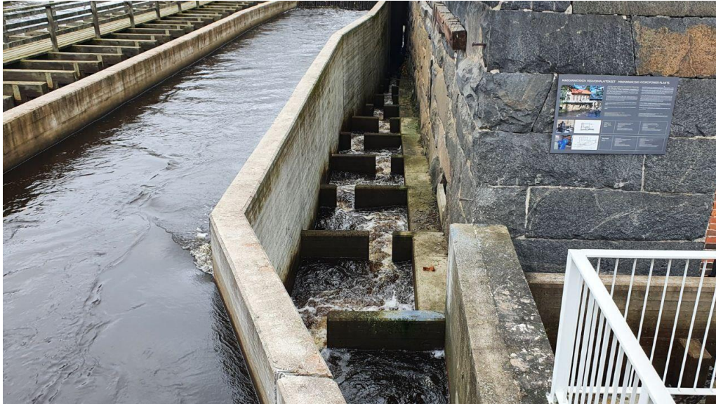
Kuva 1: Makkarakosken kalatie Noormarkussa on tyypillinen pystyrakokalatie, jossa väliseinät muodostavat altaita ja hallitsevat virtausta.
