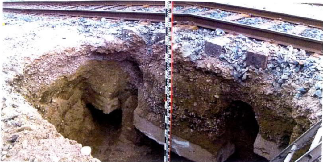
Kuva 25. Koekuoppa holvautuneen penkereen sivulla paaluhattukohteessa
