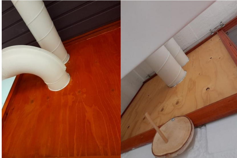
Kuvat 53 ja 54: Ilmastointikanavien läpivienti luokkahuoneisiin kohteessa I.
