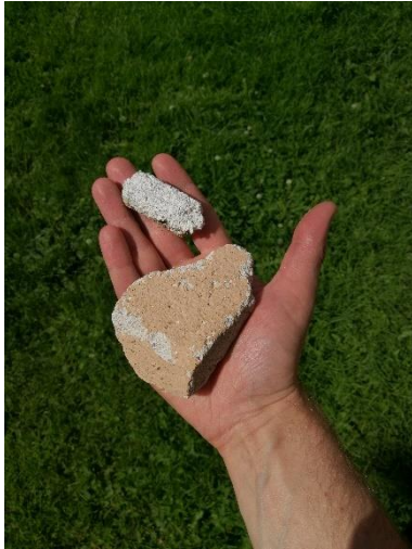
Kuva 35 Julkisivun koristeista on pudonnut joitain palasia
