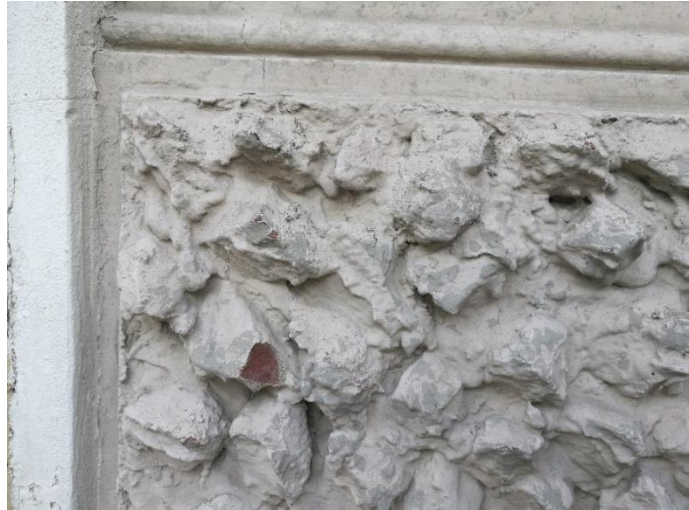
Kuva 36 Alimmassa harkotuskuviossa on pintastruktuuri luotu tiilimurskalla. Joitain rappausvaurioita on nähtävissä.
