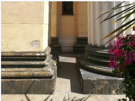
Kuva 33 Pääsisäänkäynnin läheisyydessä kolossaalipylväikössä on pintavaurioita.
