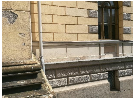
Kuva 34 Julkisivurappauksessa on pieniä vaurioita.
